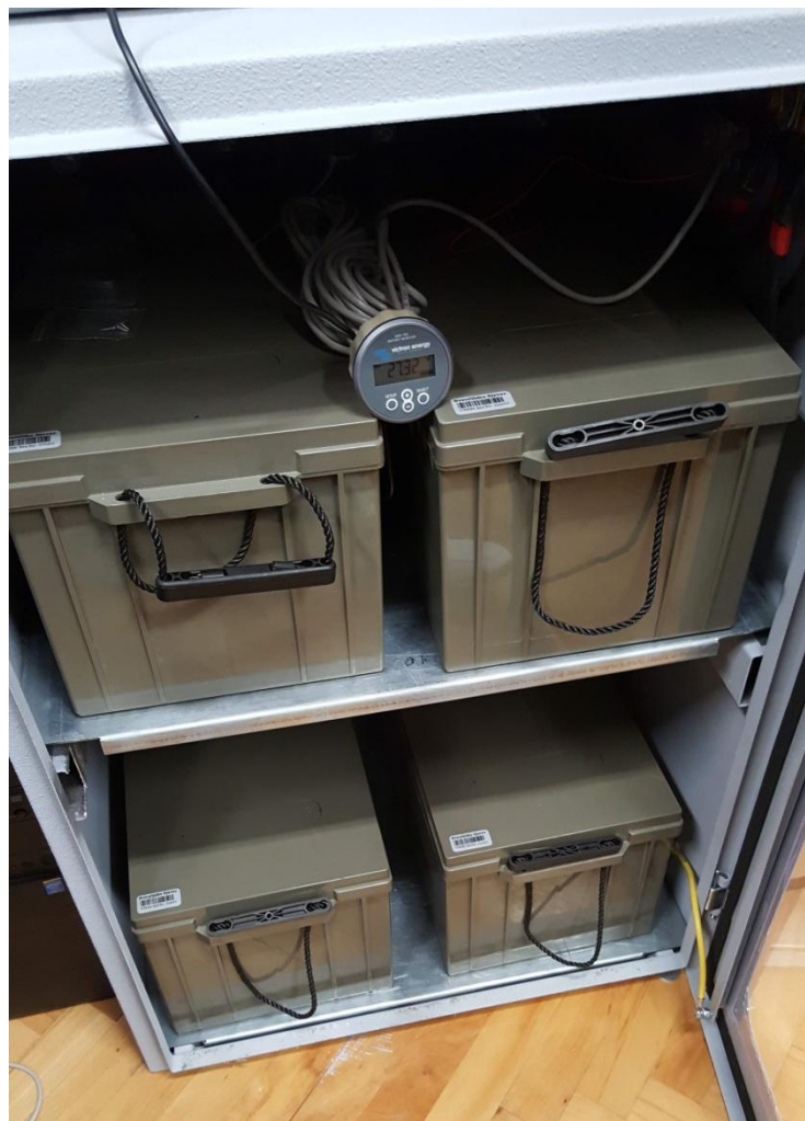
Slika 3.4 Baterijski sustav, Baterije Victron Energy AGM 12 VDC/220Ah
