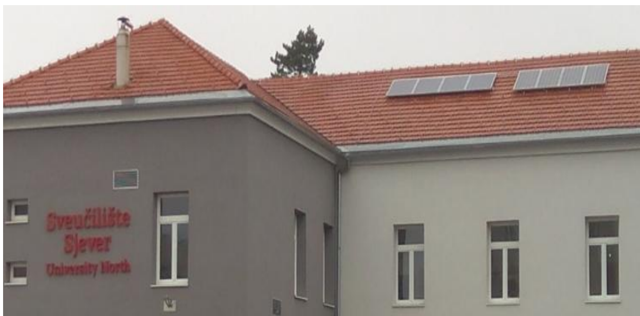
Slika 5.2: Paneli na krovu zgrade 1 Sveučilišta Sjever
