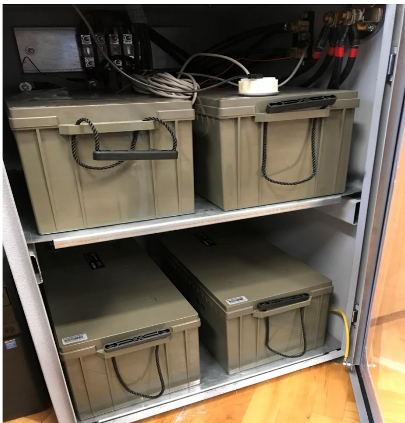
Slika 5.4: Četiri baterije u sklopu fotonaponskog sustava Sveučilišta Sjever
