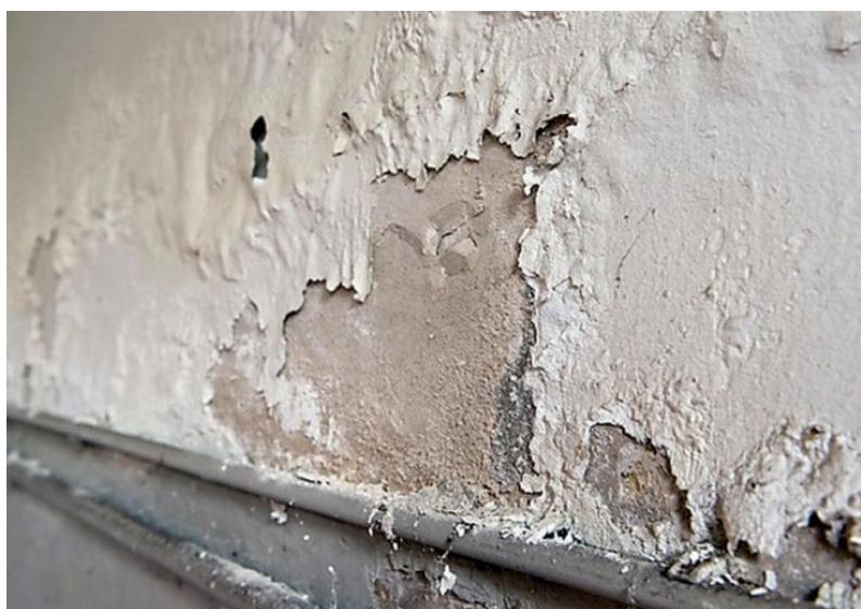
Slika 22. Oštećenje žbuke uzrokovano vlagom
