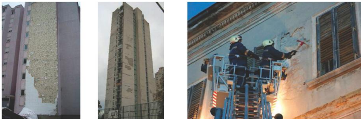
Slika 5., 6., 7. Propadanje vanjske ovojnice zgrade
