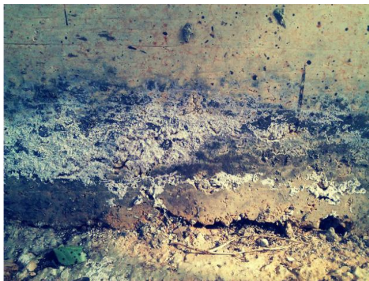
Slika 4. Kristalizacija soli na betonskom zidu
