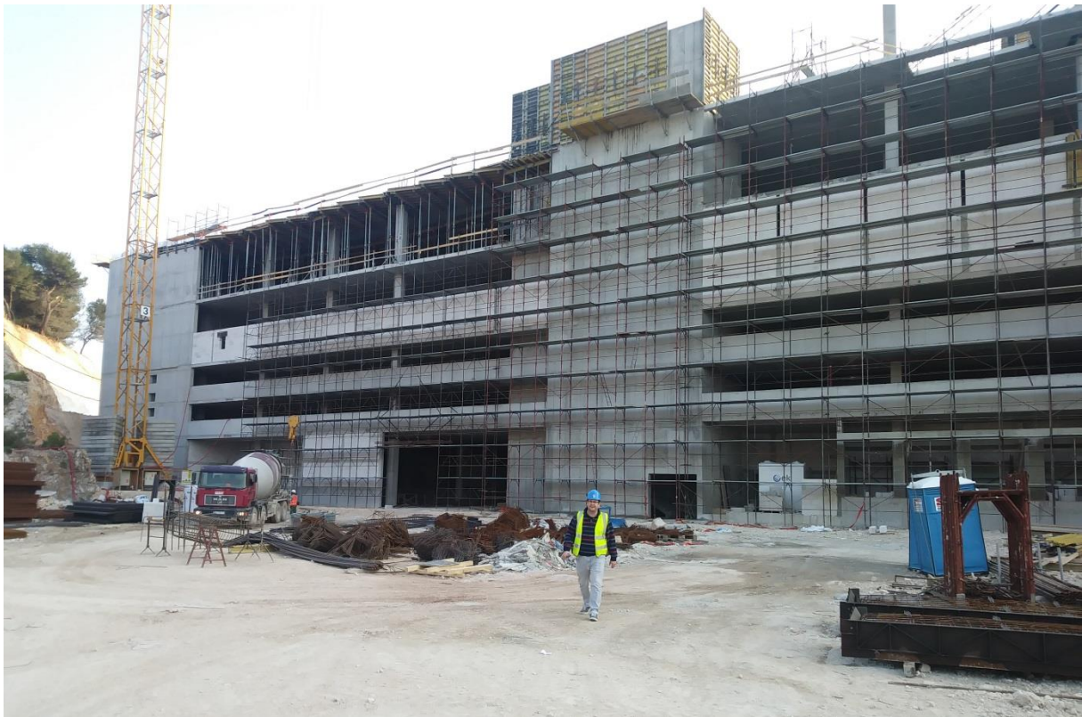
Slika 4.4 Završetak betonskih radova kompletne građevine i postavljanje fasade ( na slici prikazan dio građevine)
