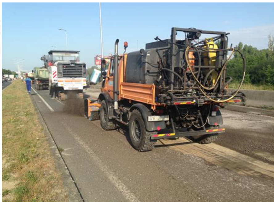
Slika 17. Strojno čišćenje asfaltnog kolnika sa strojnim četkama (izvor: baza podataka Zagrebačke ceste)
