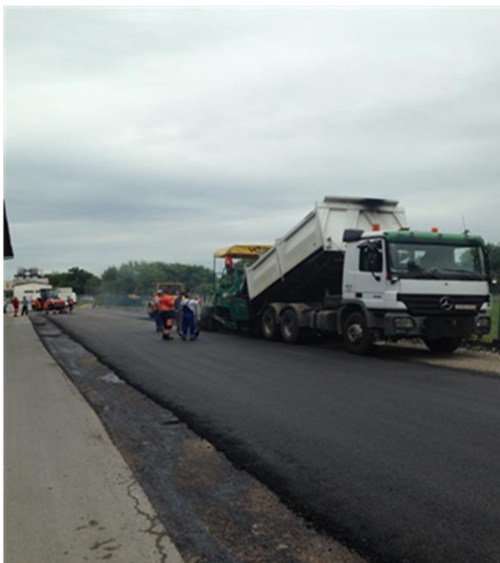
Slika 4. Strojna ugradnjaasfaltne mješavine BNS 22 (AC 22-N) – Zagreb Žitnjak(izvor: baza podataka Zagrebačke ceste)
