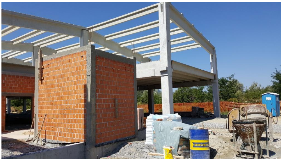
Slika 3.6. Zidanje zidova šupljom blok opekom, na slici vidljivi i horizontalni i vertikalni serklaži
