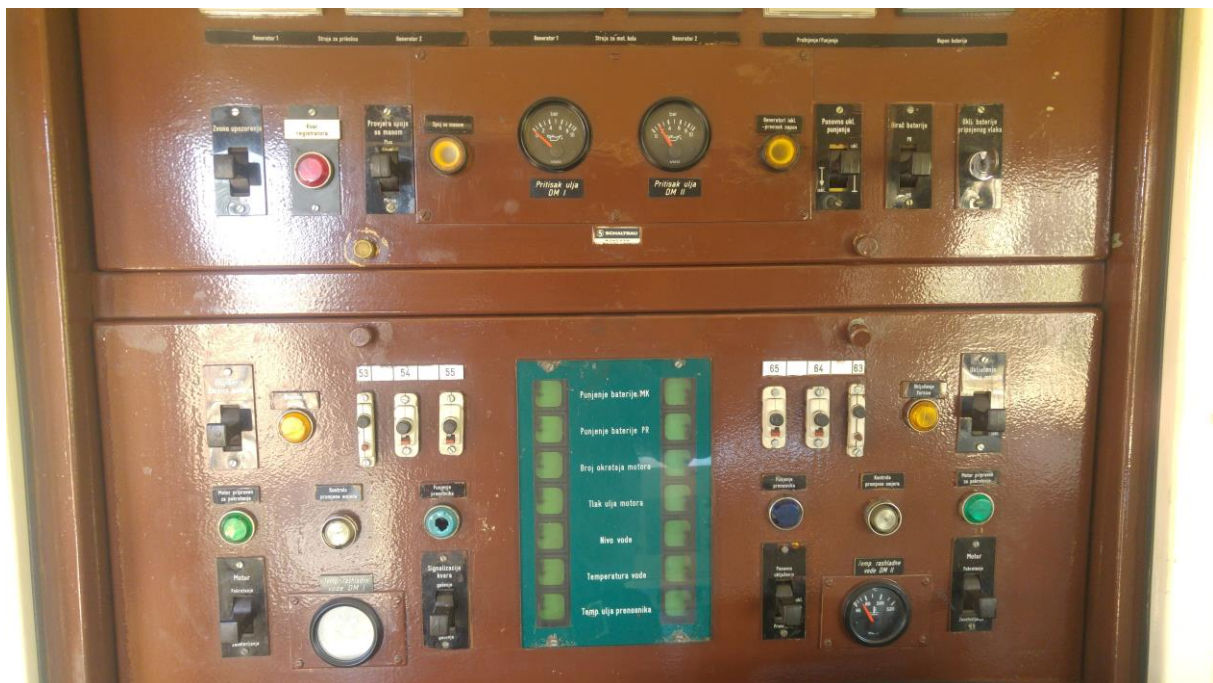
Slika 2.12.1 Upravljački ormar sa indikatorima kvarova
