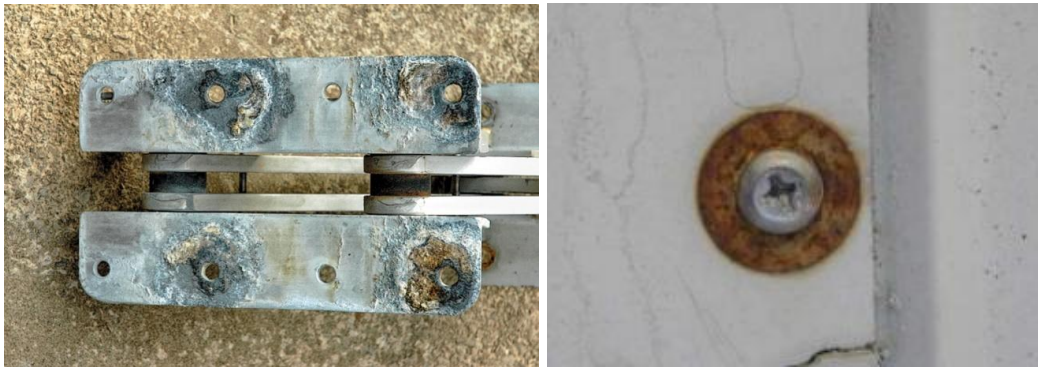
Slika 7. Galvanska korozija okovnja, korozija ploške u spremniku [4, 27]
