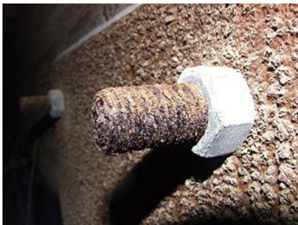
Slika 3. Elektrokemijska korozija u spremniku s vodom [45]
