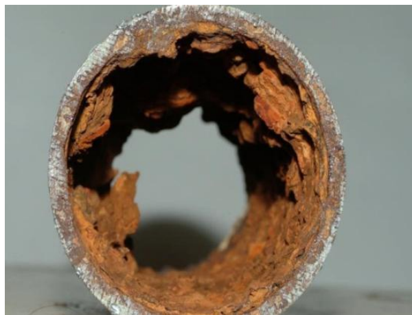
Slika 2. Kemijska korozija u ispušnoj cijevi [44]
