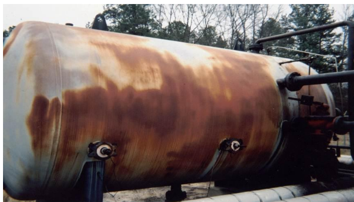
Slika 4. Primjer opće korozije na spremniku[24]
