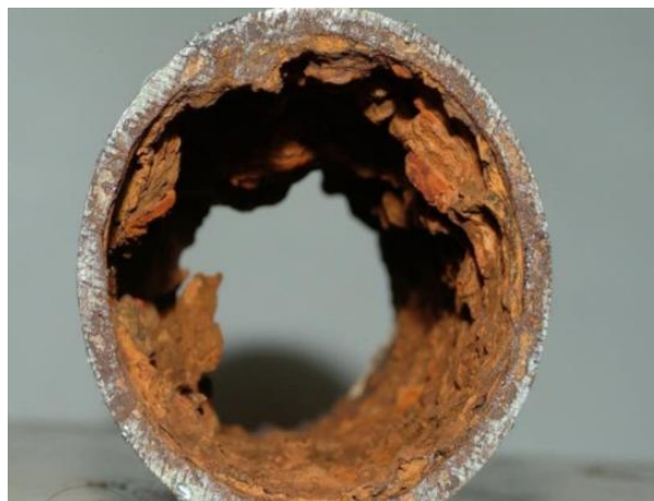
Slika 2. Kemijska korozija u ispušnoj cijevi [44]
