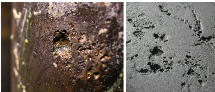
Slika 5. Primjeri rupičaste korozije [25,46]
