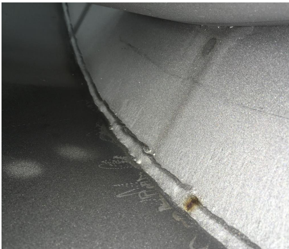
Slika 15: Pogreška oblika zavora zbog loše tehnike zavarivanja
