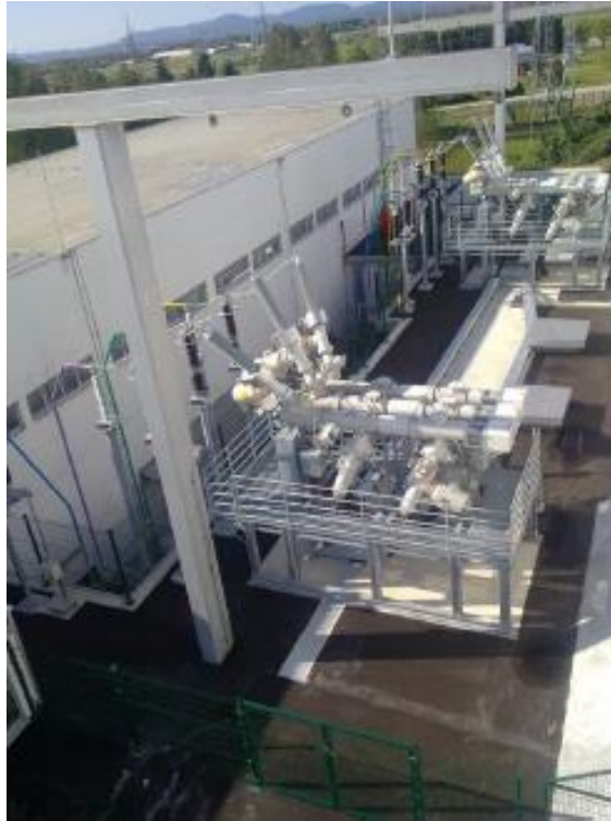
Slika 3.4. Postojeće rasklopno postrojenje 110 kV [2]
