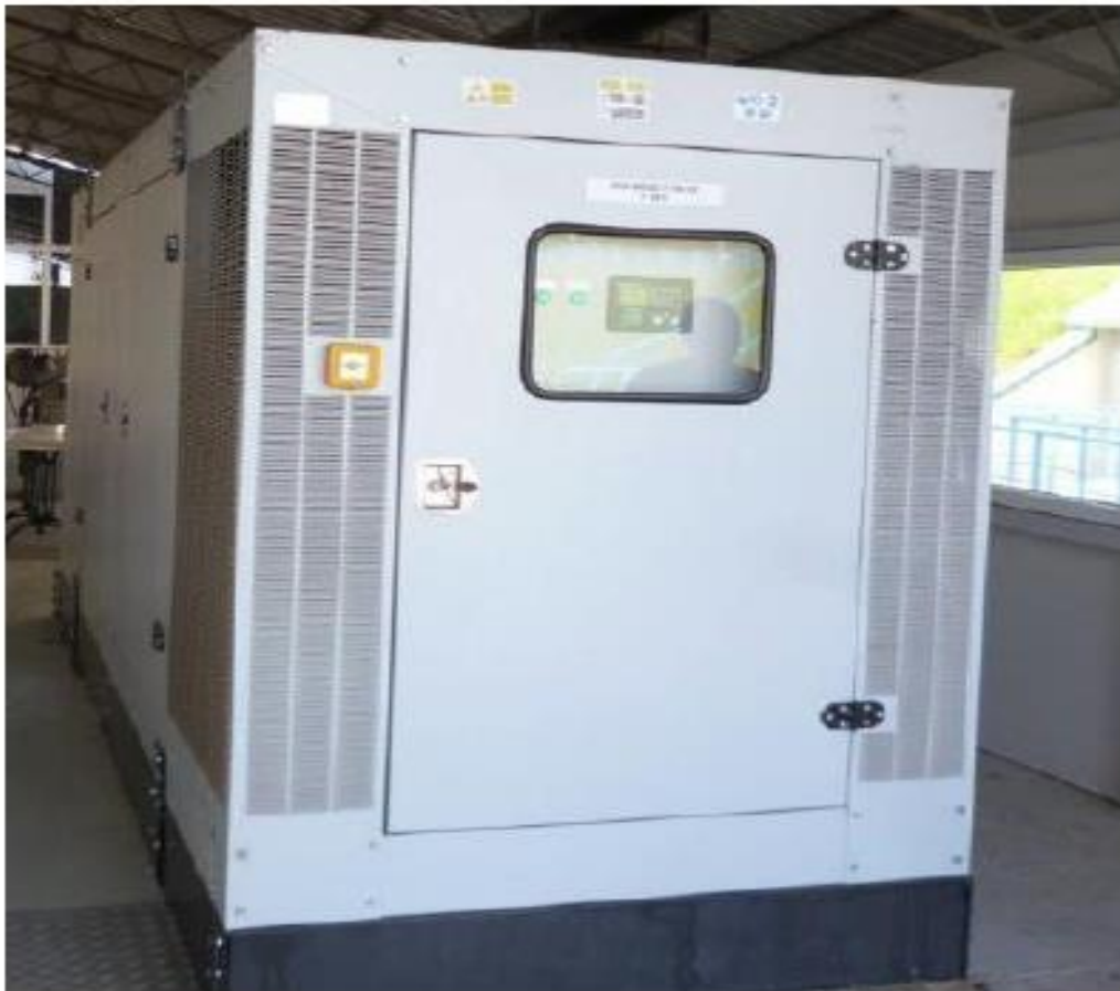
Slika 2.6. Postojeći diesel agregat 400 kVA za rezervno napajanje vlastite potrošnje elektrane [7]
