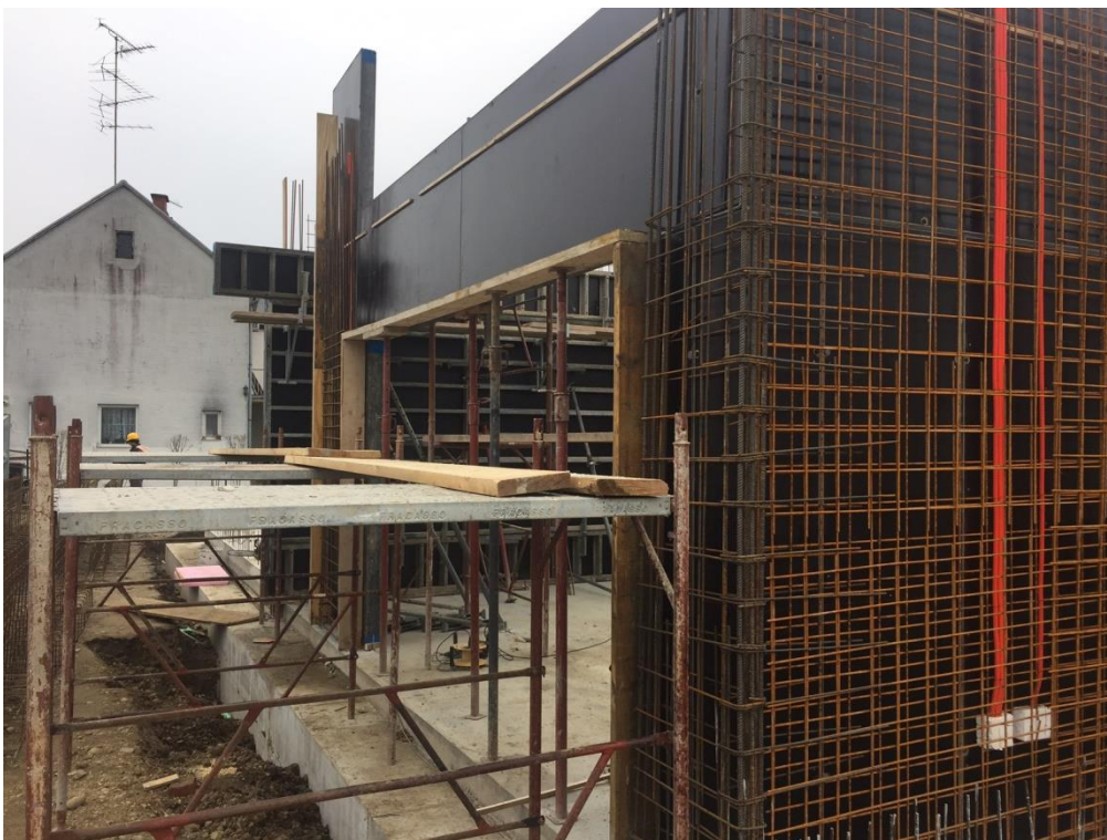
Slika br. 6. Oplata nosivih zidova, (izvor: vlastiti)
