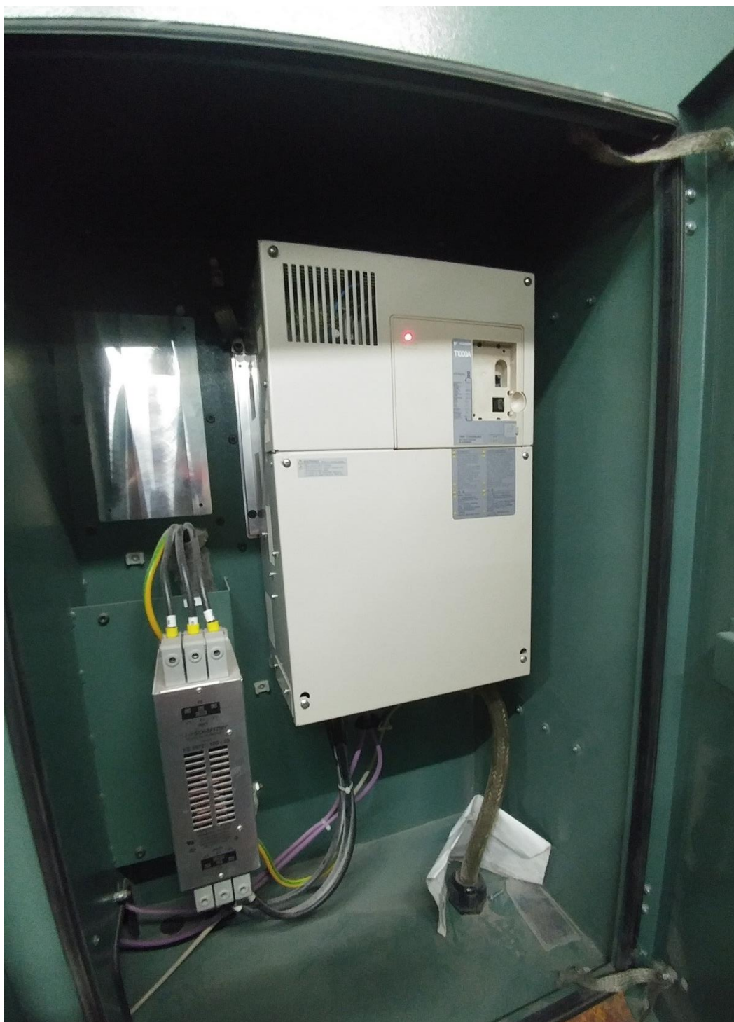
Slika 6.4. Elektro ormar sa frekvencijskim pretvaračem
