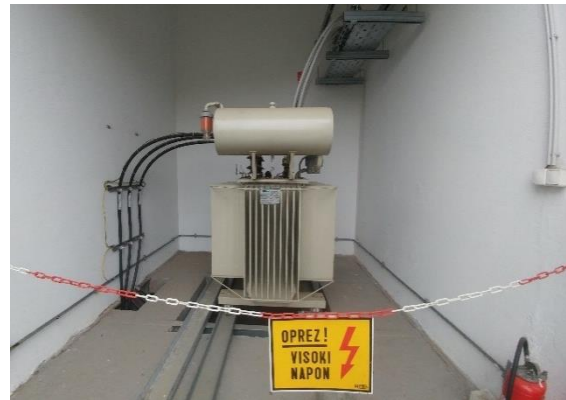
Slika 4.2. Energetski transformator proizvođača Končar jačine 1000kVA
