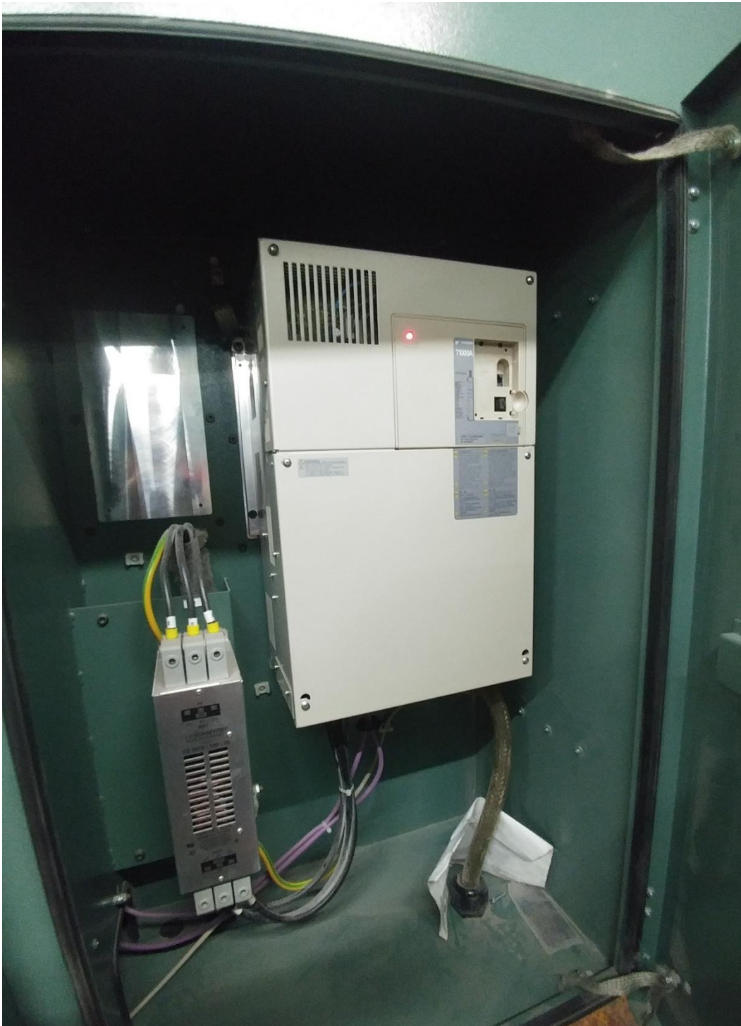
Slika 6.4. Elektro ormar sa frekvencijskim pretvaračem
