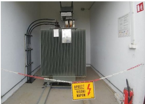
Slika 4.1. Energetski transformator proizvođača ABB jačine 2500kVA
