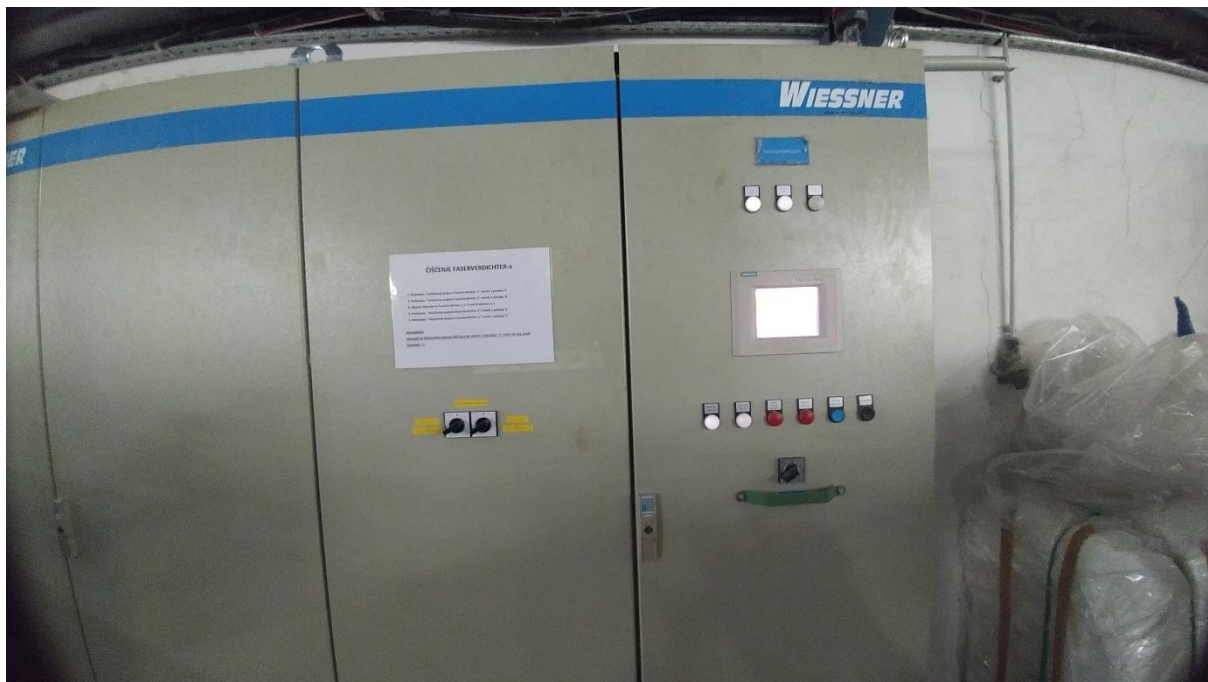
Slika 5.1. Upravljački ormar filtera
