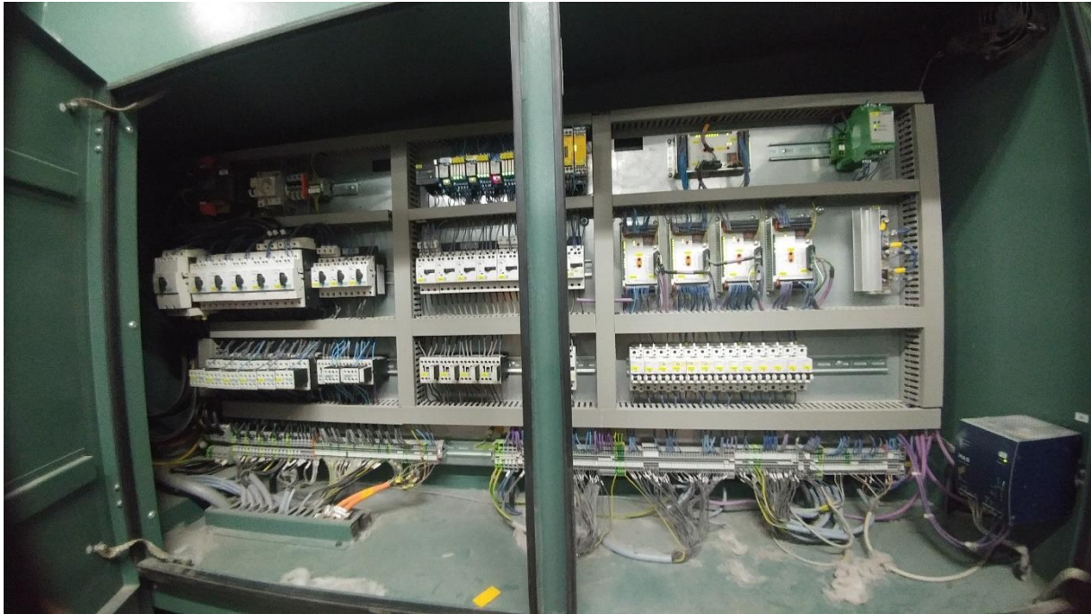
Slika 6.2 Elektro ormar stroja J20
