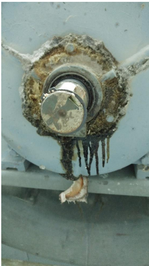
Slika 4.11. Curenje masti iz 30 kW asinkronog elektromotora zbog povišene temperature
