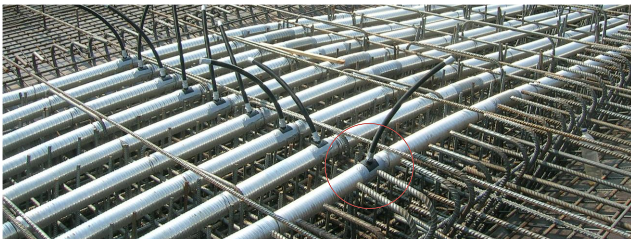
Slika 2.6 Kontrolne cijevi za odzračivanje
