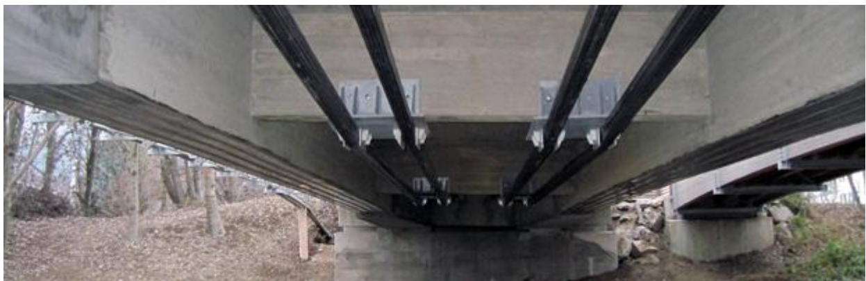
Slika 2. Kabeli izvan betonskog presjeka
