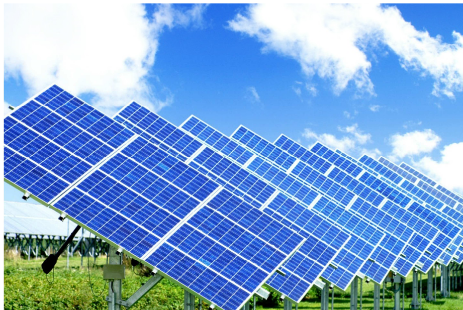
Slika 3.5. Pomični fotonaponski sistemi
