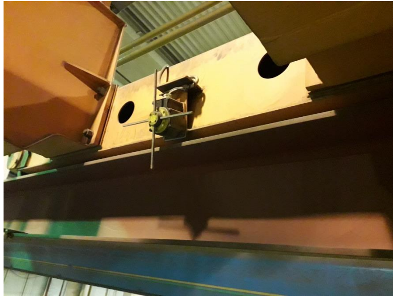
Slika 4.6: Krajnji isključivač instaliran na konstrukciju dizalice [20]
