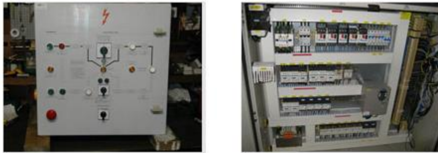
Slika 3.13: Elektro razvodni ormari [5]
