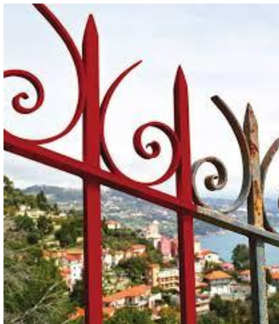
Slika 3.5. Ograda obojena temeljnom bojom koja sadrži minij
