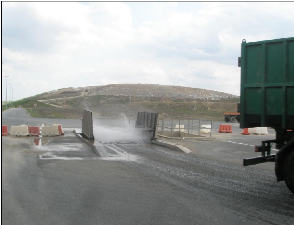
Slika 3.3. Automatski perać kotača kamiona i ostalih korisnika odlagališta otpada
