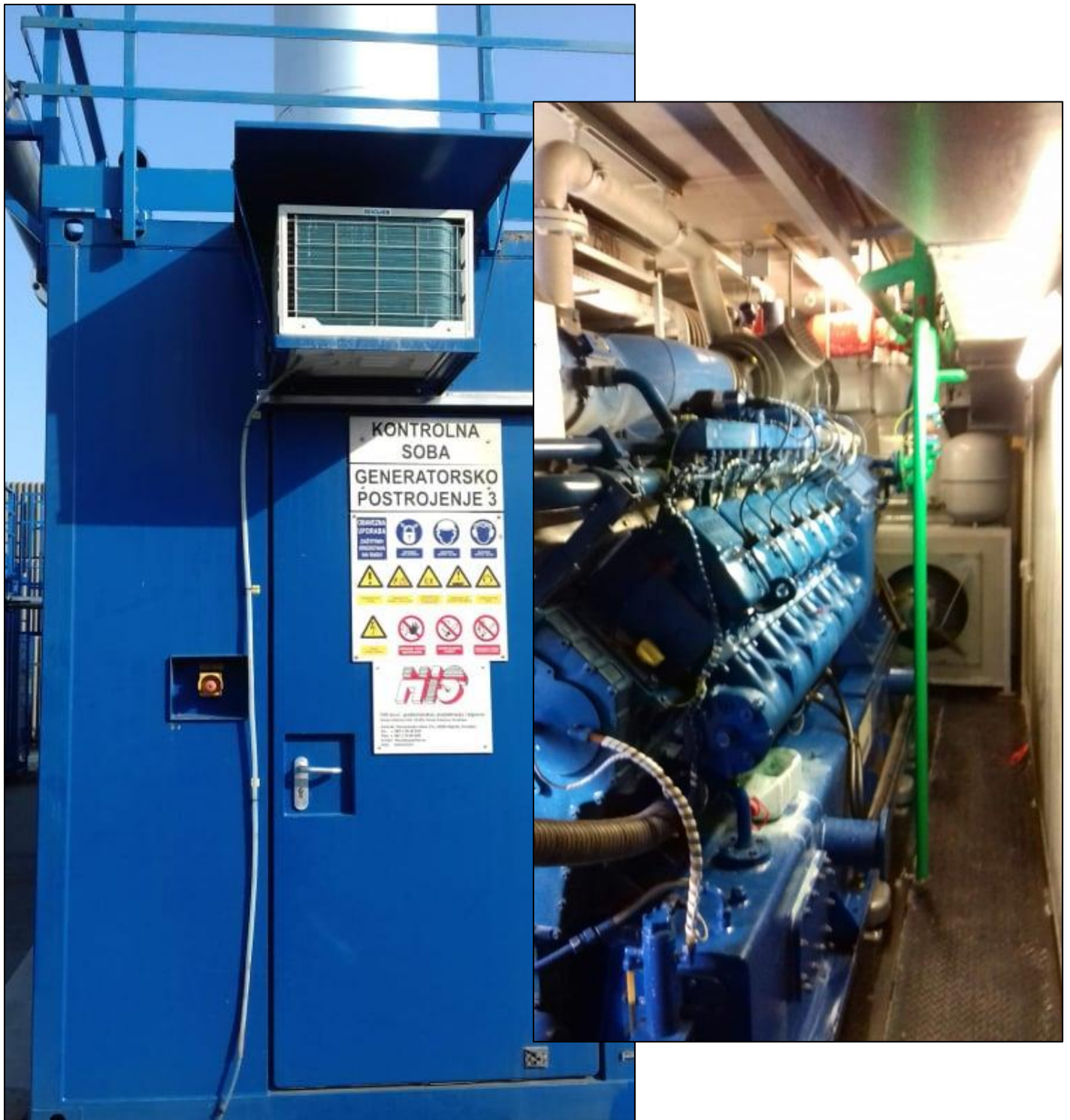
Slika 7.1. i 7.2. Ulaz u kontejner generatorskog postrojenja i sama unutrašnjog motora
