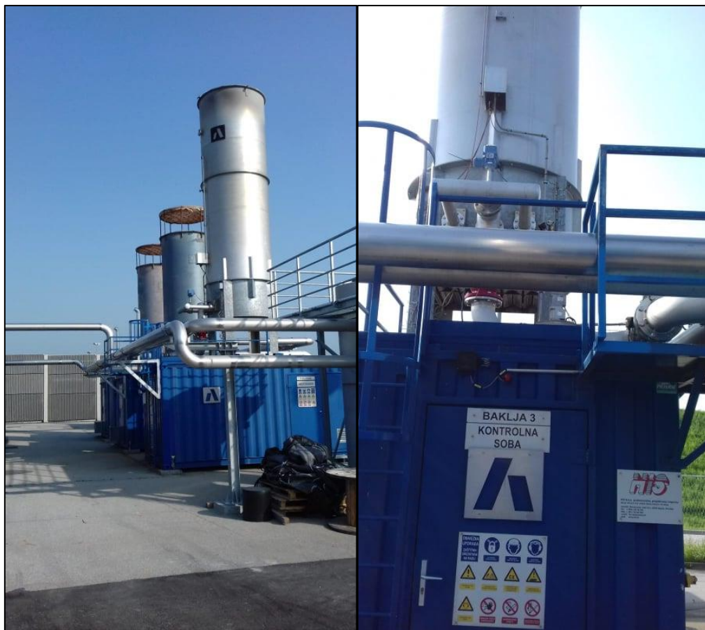
Slika 8.1. i 8.2. Visokotemperaturne baklje s kompresorima
