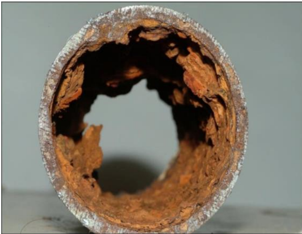
Slika 1.2 Kemijska korozija u cijevima [8]
