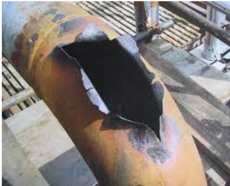
Slika 1.11 Erozijsko korozivno oštećenje cjevovoda za transport nafte [13]
