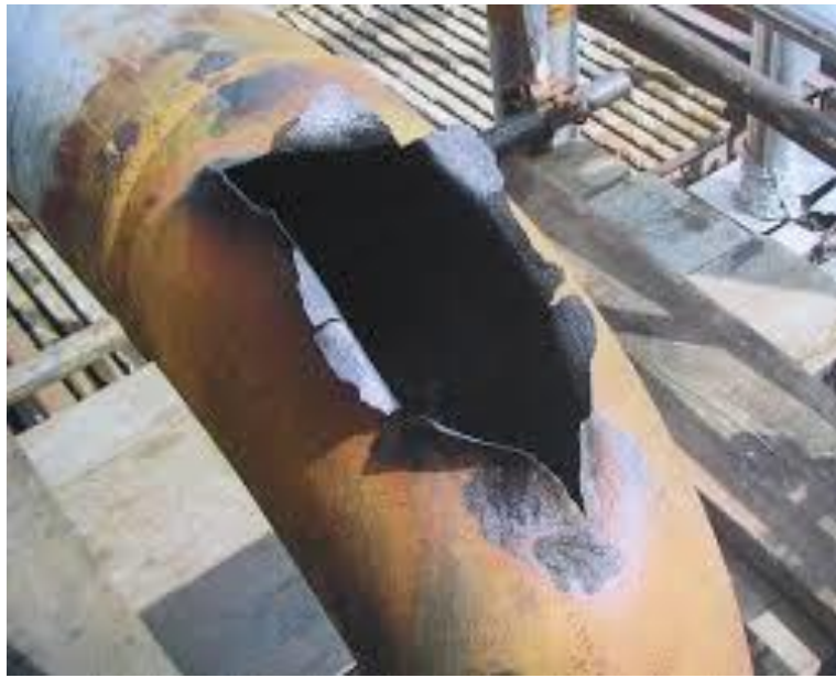
Slika 1.11 Erozijsko korozijsko oštećenje cjevovoda za transport nafte [13]
