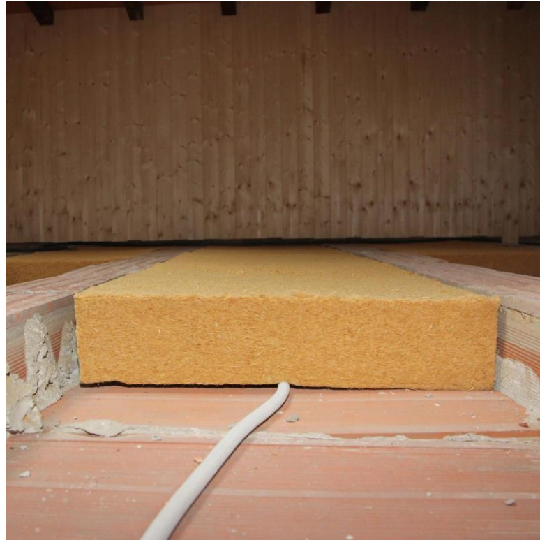
Slika 4.16 Podna izolacija od drvenih vlakana
