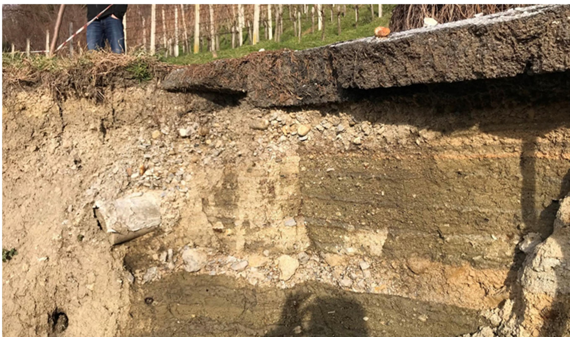
Slika 10. Izlaz cijevi u tijelo klizišta (cijev zaštopana)
