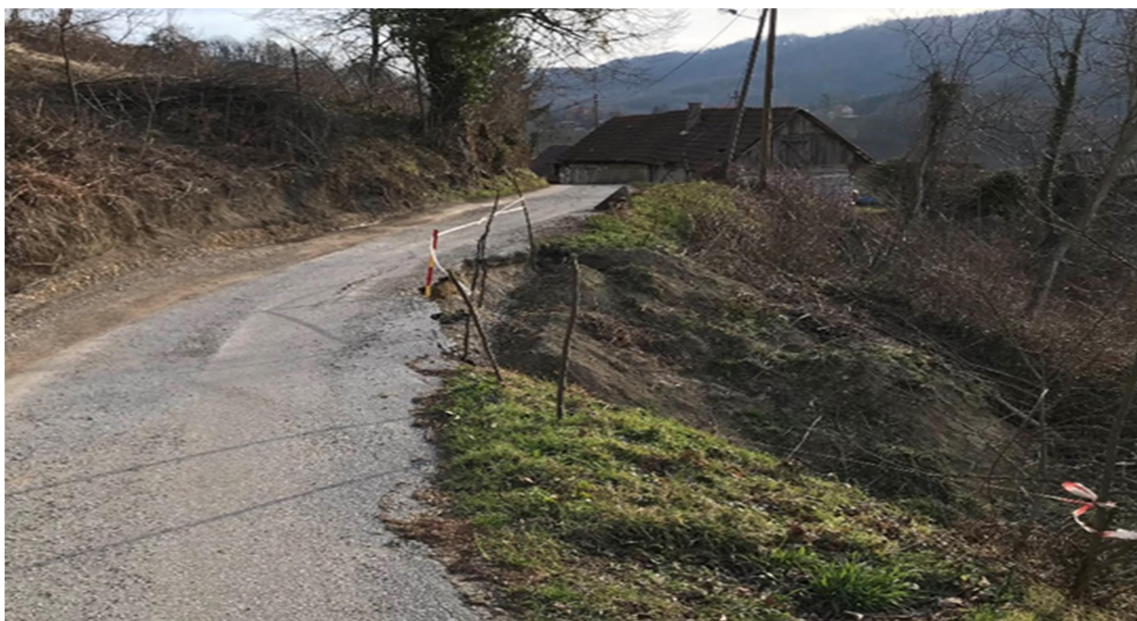
Slika 11. Jasno vidljivo čelo klizišta
