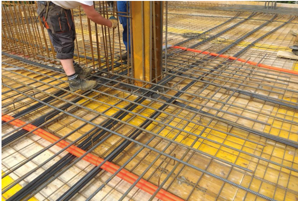
Slika 2.13. Slobodno vođenje kabela na gradilištu
