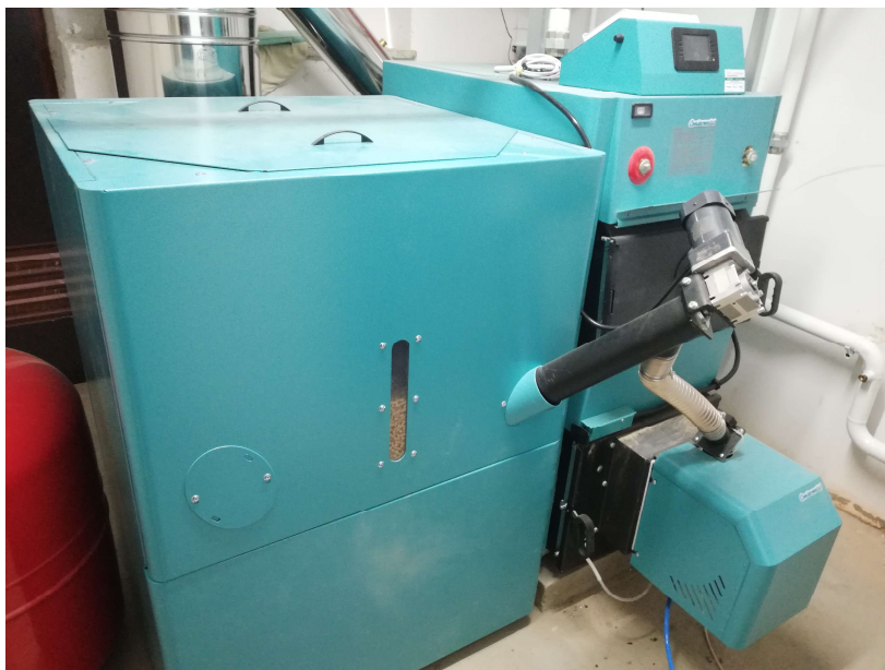
Slika 3.4.1 Postojeći kotao na pelete
