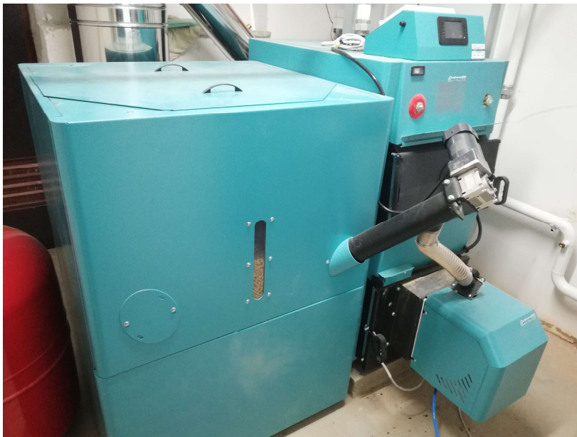
Slika 3.4.1 Postojeći kotao na pelete
