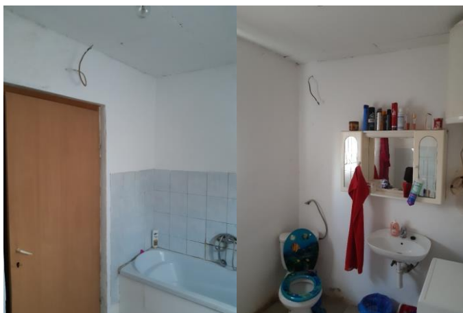
Slika 6. i 7. postojeće stanje kupaonice
