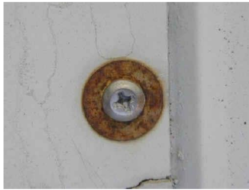
Slika 9.: Primjer kontaktne korozije [8]
