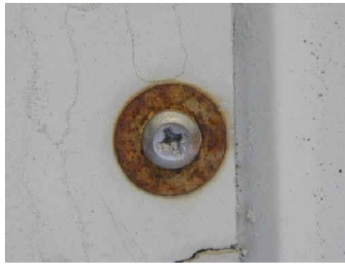
Slika 9.: Primjer kontaktne korozije [8]
