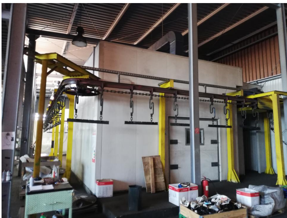
Slika 2.18 Linija za bitumenizaciju uranjanjem [15]
