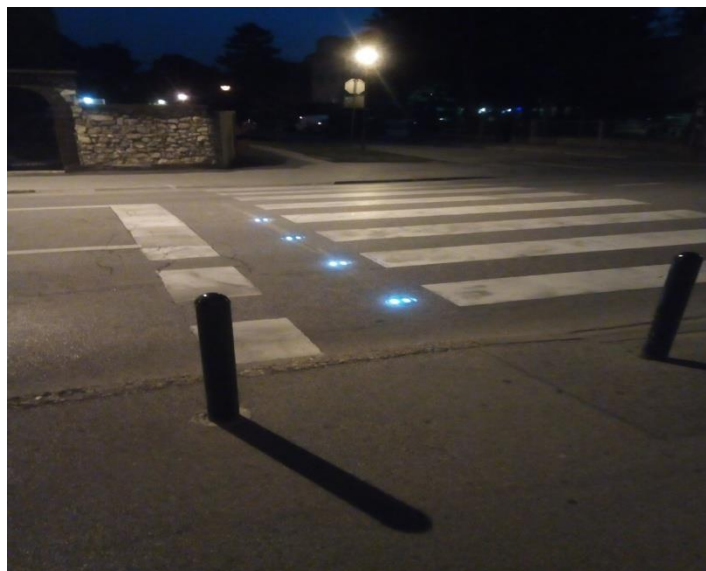
Slika 15. LED diode za dodatno isticanje pješačkog prijelaza
