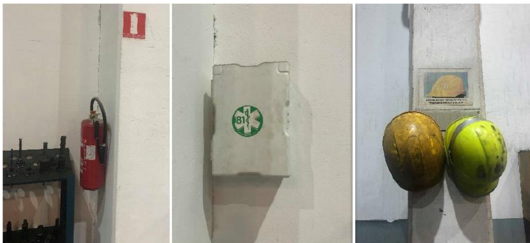
Slika 44. Protupožarni aparat, kutija prve pomoći i kacige
