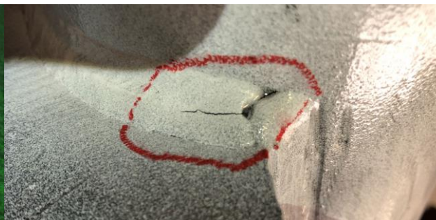
Slika 8 Pukotina zavara detektirana MT [7]
