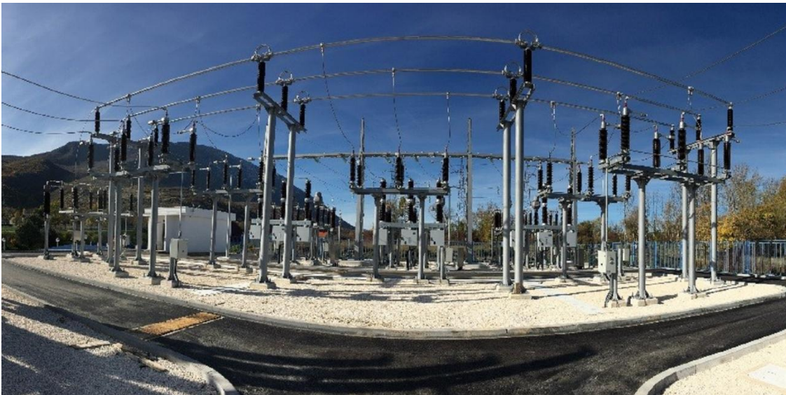
Slika 2.4 Rasklopno postrojenje od 110 kV [7]
