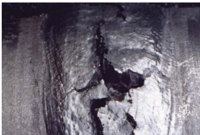
Slika 6. Posljedica pojave interkristalne korozije
