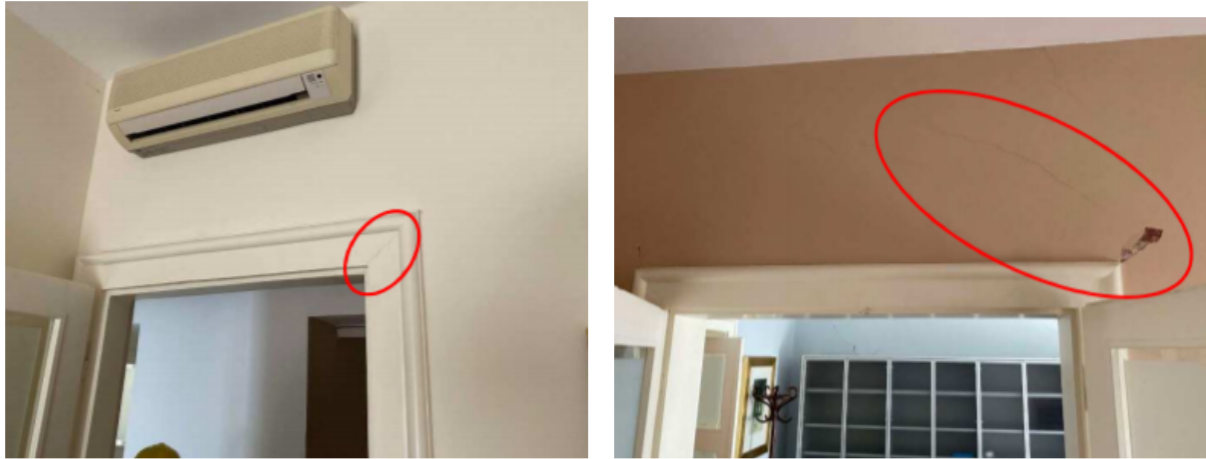
Slika 5.8. - Dijagonalne pukotine na unutarnjim otvorima zidova
