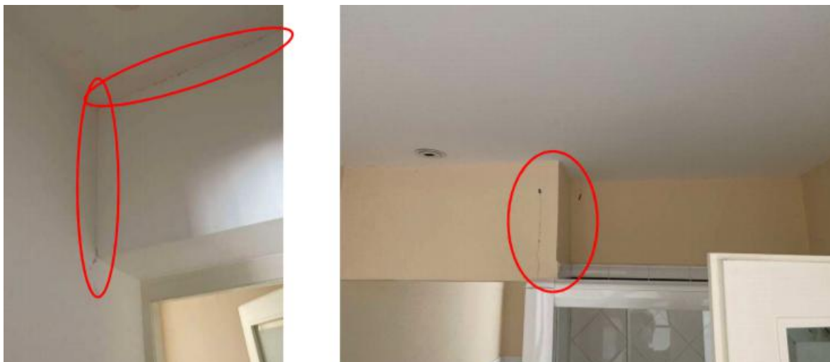
Slika 5.7. - Vertikalne i horizontalne površinske pukotine
