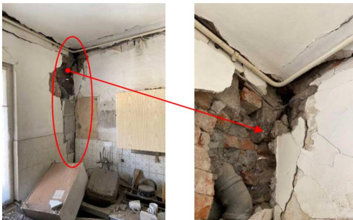
Slika 5.14. - Razarajuće oštećenje sjeveroistočnog kuta stana i zgrade
