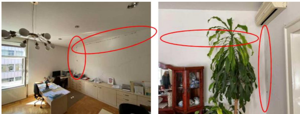
Slika 5.11. - Horizontalne pukotine na pregradnom (lijevo) i na unutarnjem nosivom zidu (desno)
