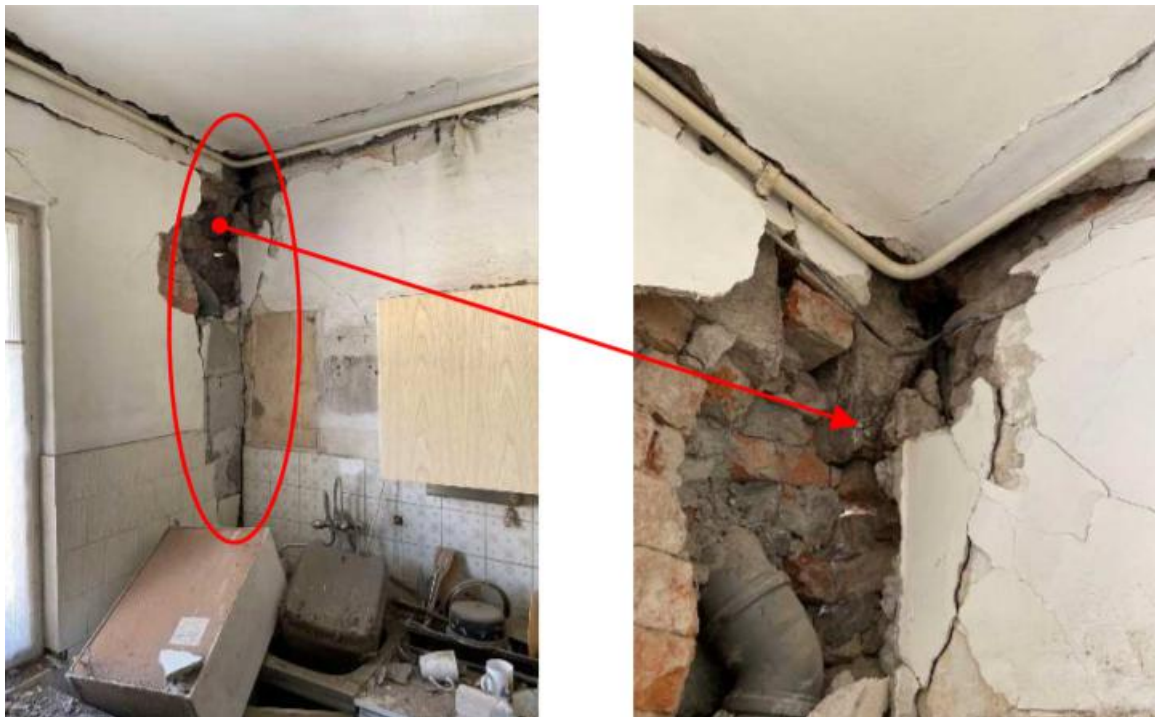
Slika 5.14. - Razarajuće oštećenje sjeveroistočnog kuta stana i zgrade
