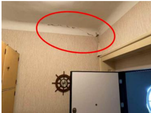
Slika 5.27. - Horizontalne pukotine uzduž stubišnog zida
