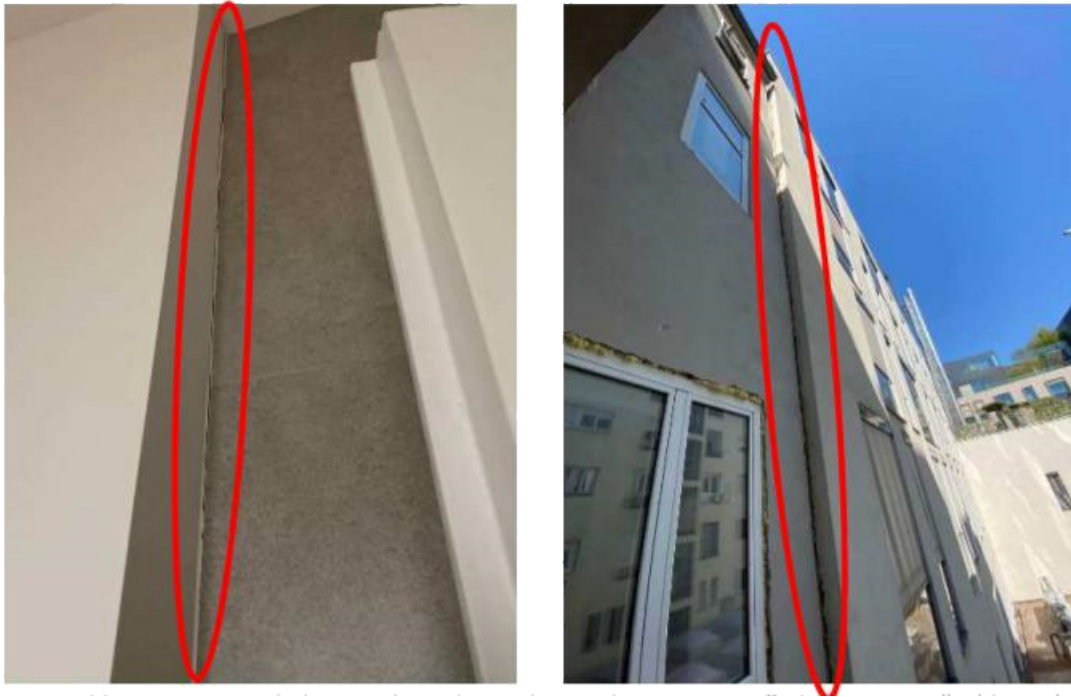
Slika 5.34. - Vertikalna strukturalna pukotina koja se proteže kroz sve etaže (desno)
