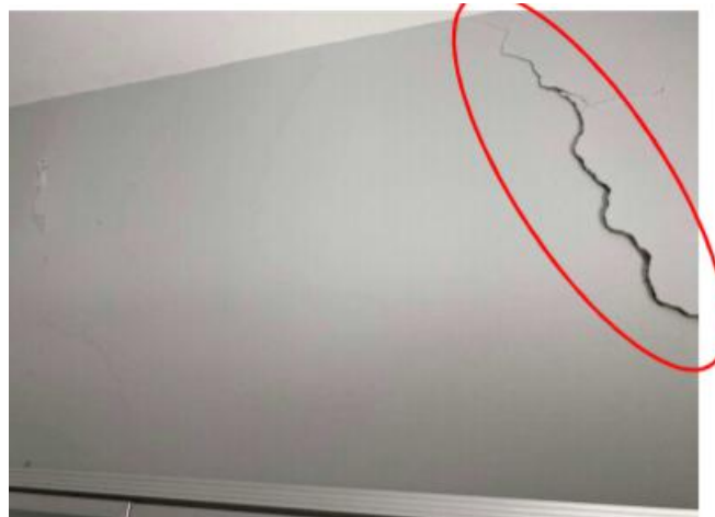
Slika 5.9. - Pukotina na pregradnim zidovima unutrašnjosti stana
