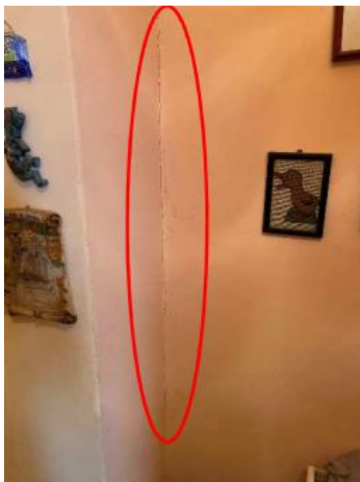
Slika 5.36. - Vertikalna pukotina na spojevima zidova
