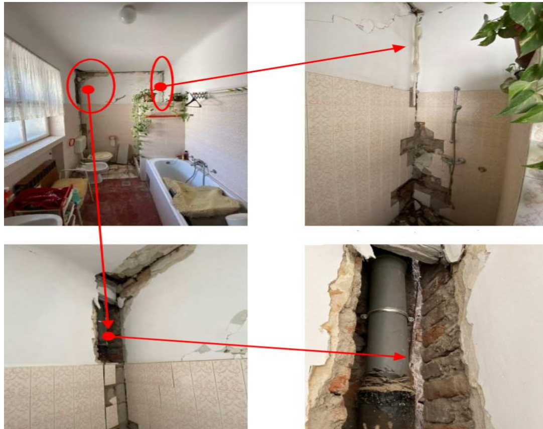
Slika 5.22. - Pukotinsko oštećenje te lom sjeveroistočnog kuta zgrade
