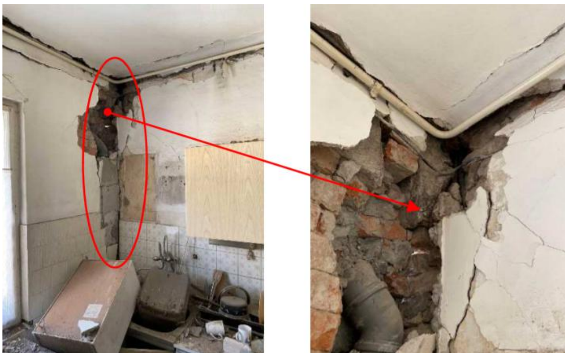
Slika 5.14. - Razarajuće oštećenje sjeveroistočnog kuta stana i zgrade
