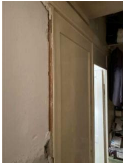
Slika 5.28. - Odvajanje okvira vrata zbog potresnog udara
