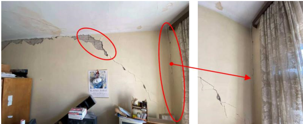
Slika 5.31. - Dijagonalna pukotina te njezino propagiranje do vertikalne pukotine na vanjskom nosivom zidu
