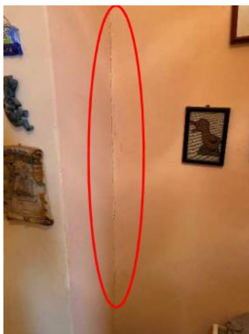
Slika 5.36. - Vertikalna pukotina na spojevima zidova
