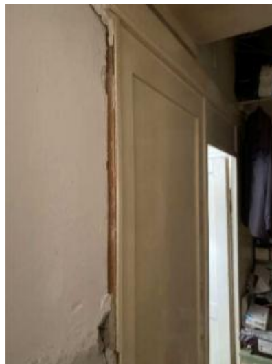
Slika 5.28. - Odvajanje okvira vrata zbog potresnog udara
