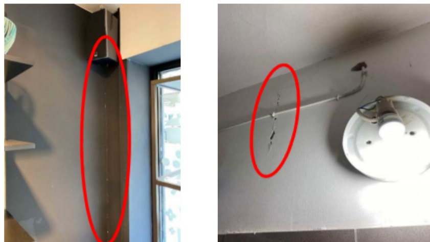
Slika 5.4. - Površinske pukotina po istočnom zidu
