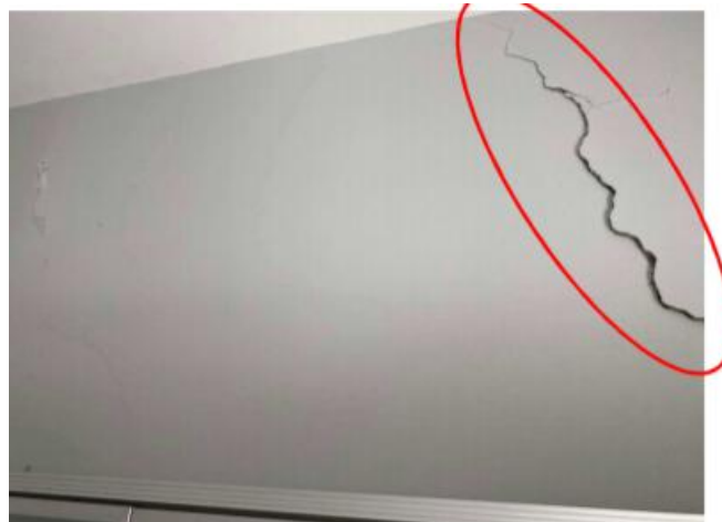
Slika 5.9. - Pukotina na pregradnim zidovima unutrašnjosti stana
