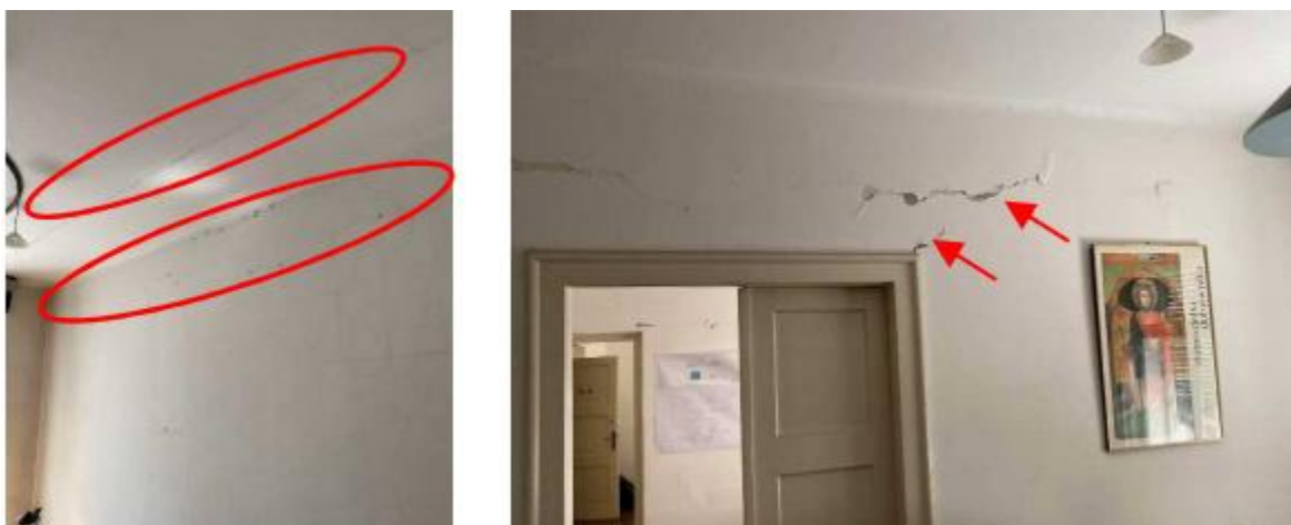
Slika 5.39. - Pukotinski sustav na pregradnom zidu smjera sjever-jug
