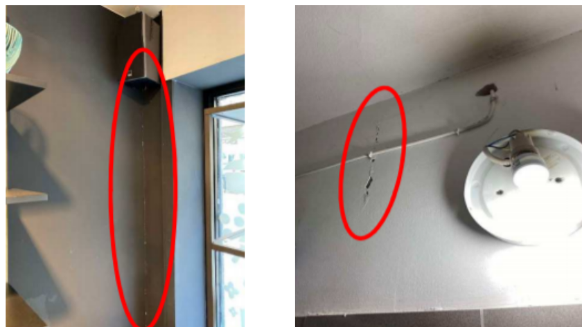
Slika 5.4. - Površinske pukotina po istočnom zidu
