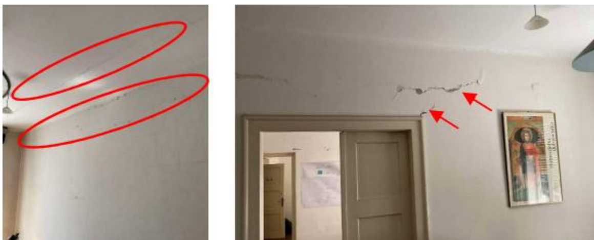
Slika 5.39. - Pukotinski sustav na pregradnom zidu smjera sjever-jug
