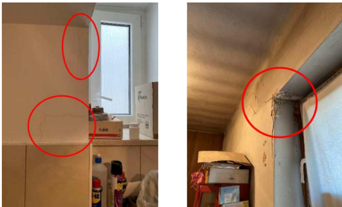
Slika 5.29. - Oštećenja primijećena na zidnim otvorima na sjevernom nosivom zidu
