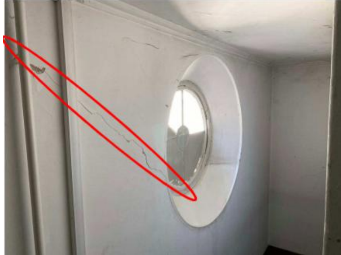
Slika 5.51. - Pukotine po vanjskim zidovima stubišta
