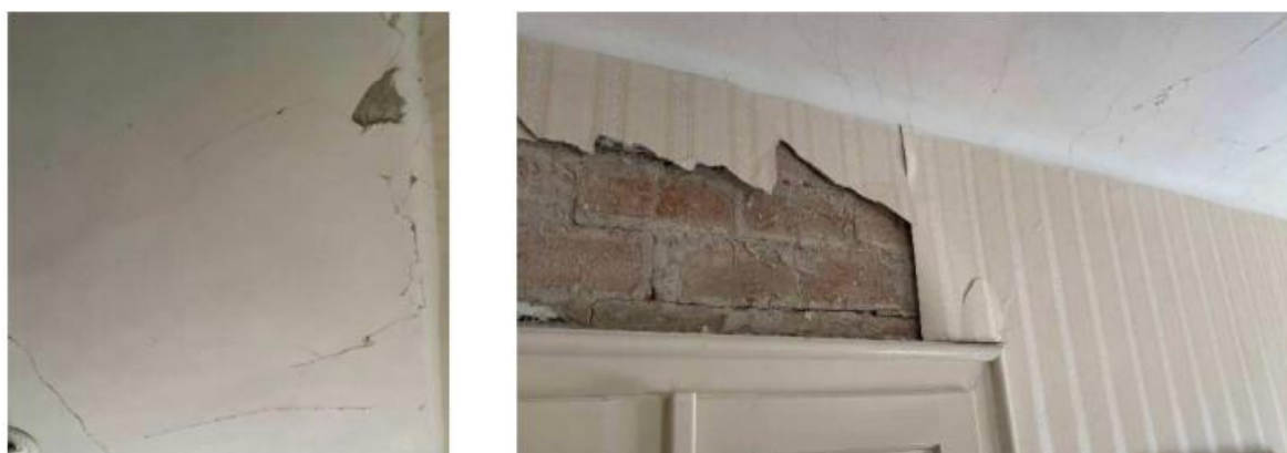
Slika 5.30. - Razvoj stropnih i zidnih pukotina
