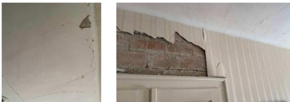
Slika 5.30. - Razvoj stropnih i zidnih pukotina
