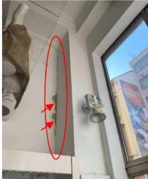
Slika 5.5. - Indikativna vertikalna pukotina na krajnjem istočnom zidu
