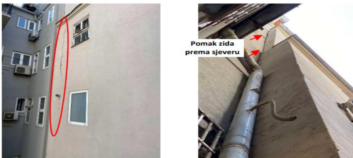
Slika 5.57. - Vertikalna pukotina na istočnom nosivom zidu
