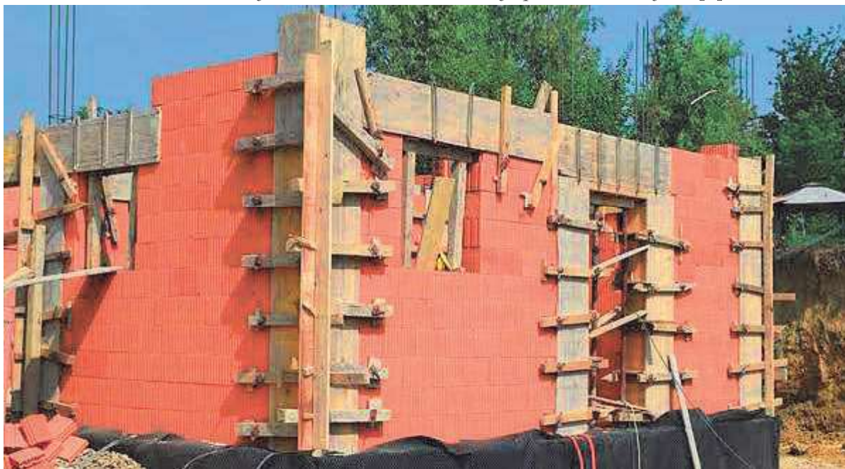
Slika 6 - Tesarski radovi, postavljanje oplatae za AB vertikalne serklaže i AB nadvoje [Izvor: https://pravimajstor.hr/stupovi-i-nadvoji ]
