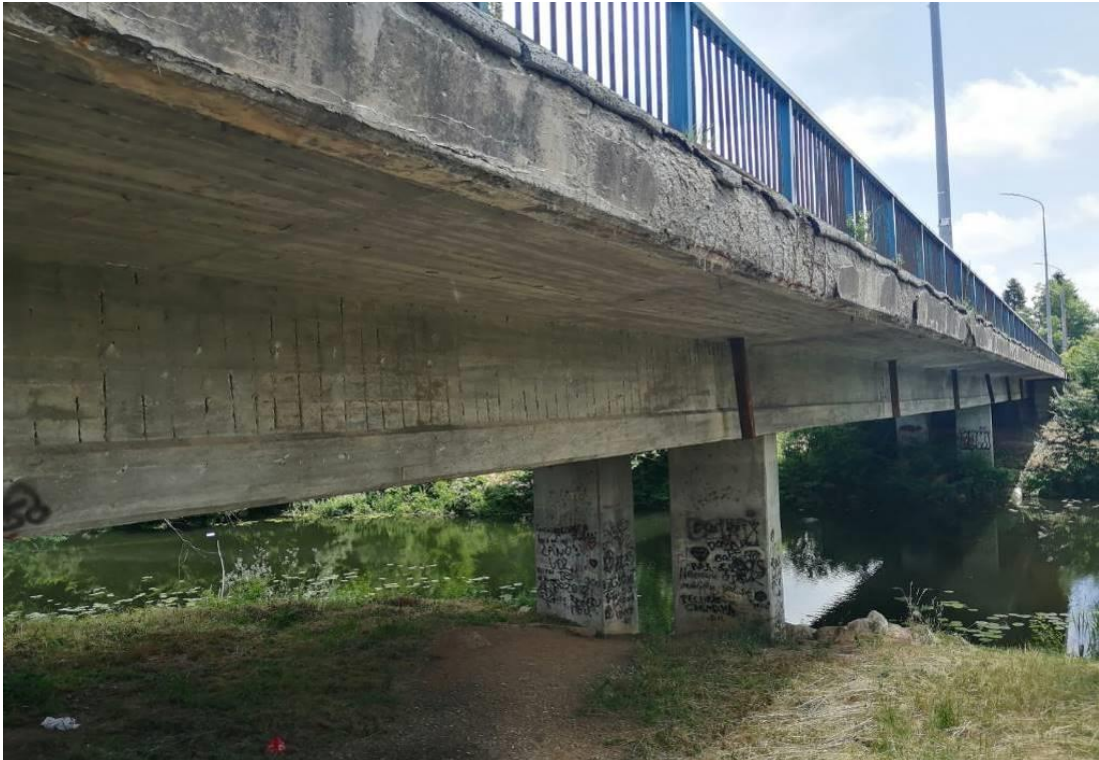
Slika 14. Oštećenja na mostu Gospić
