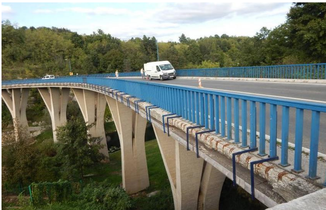
Slika 45. Zatečeno stanje mosta prije sanacijskih radova s vidljivim oštećenjima konzola
