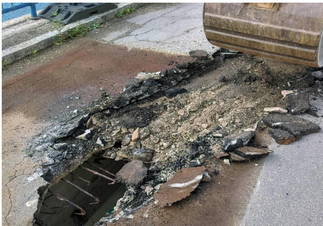
Slika 9. Oštećenje kolničke ploče mosta Klanac kod Gospića
