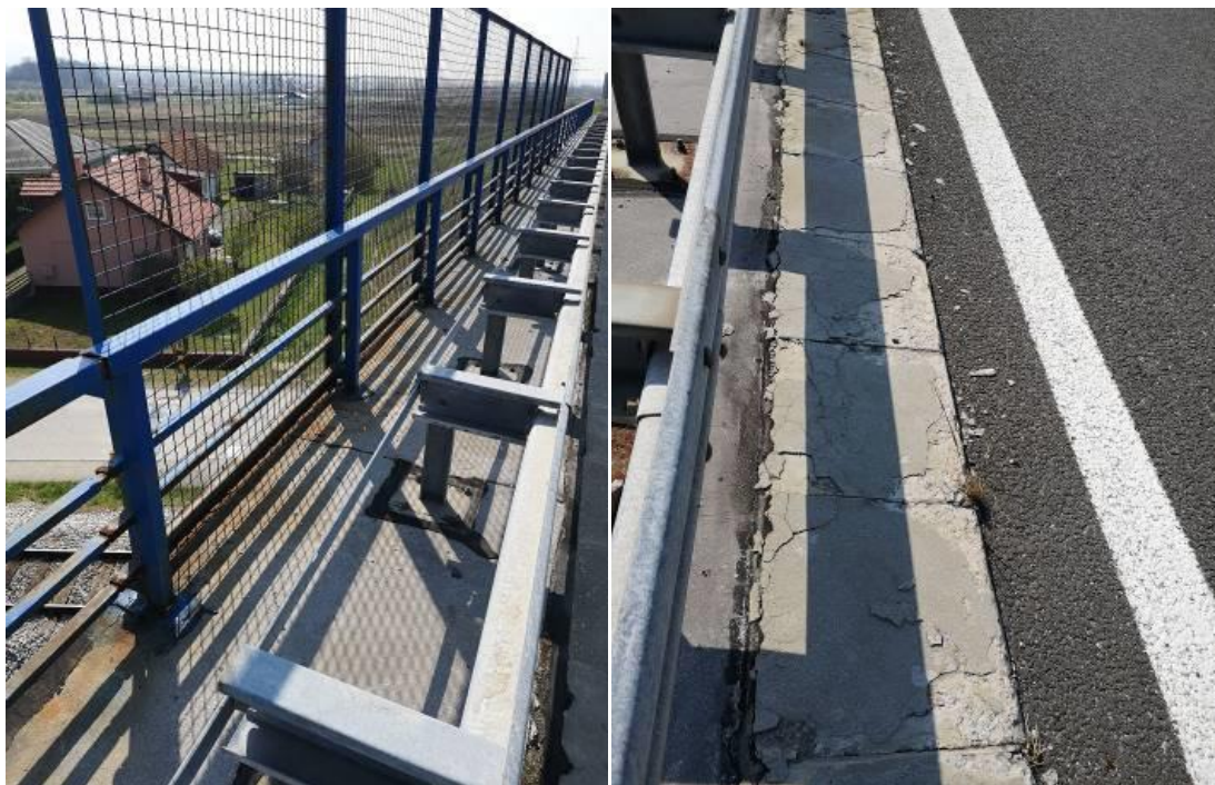
Slika 74. Oštećenja ograda, hodnika i rubnjaka nadvožnjaka
