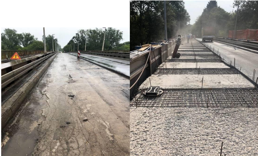
Slika 66. Oštećenja kolničke ploče i hidrodinamičko uklanjanje loših dijelova
