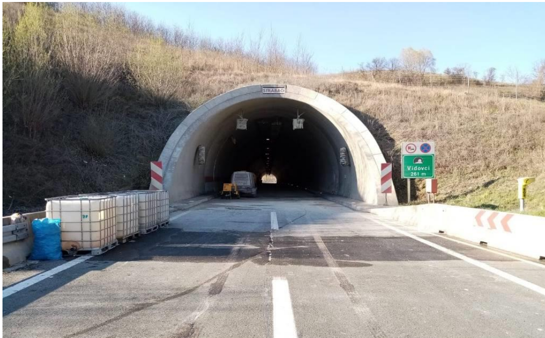
Slika 53 Zatečeno stanje obloge tunela prije izvedbe sanacijskih radova
