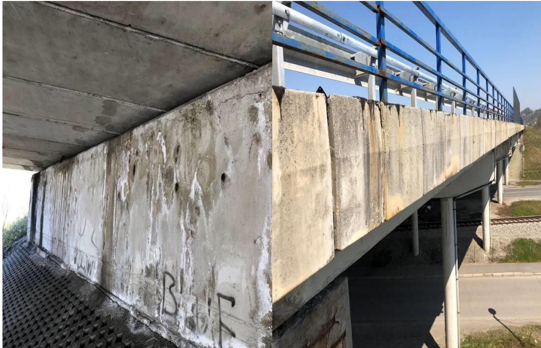
Slika 73. Oštećenja naglavne grede upornjaka, vijenaca i ograda nadvožnjaka
