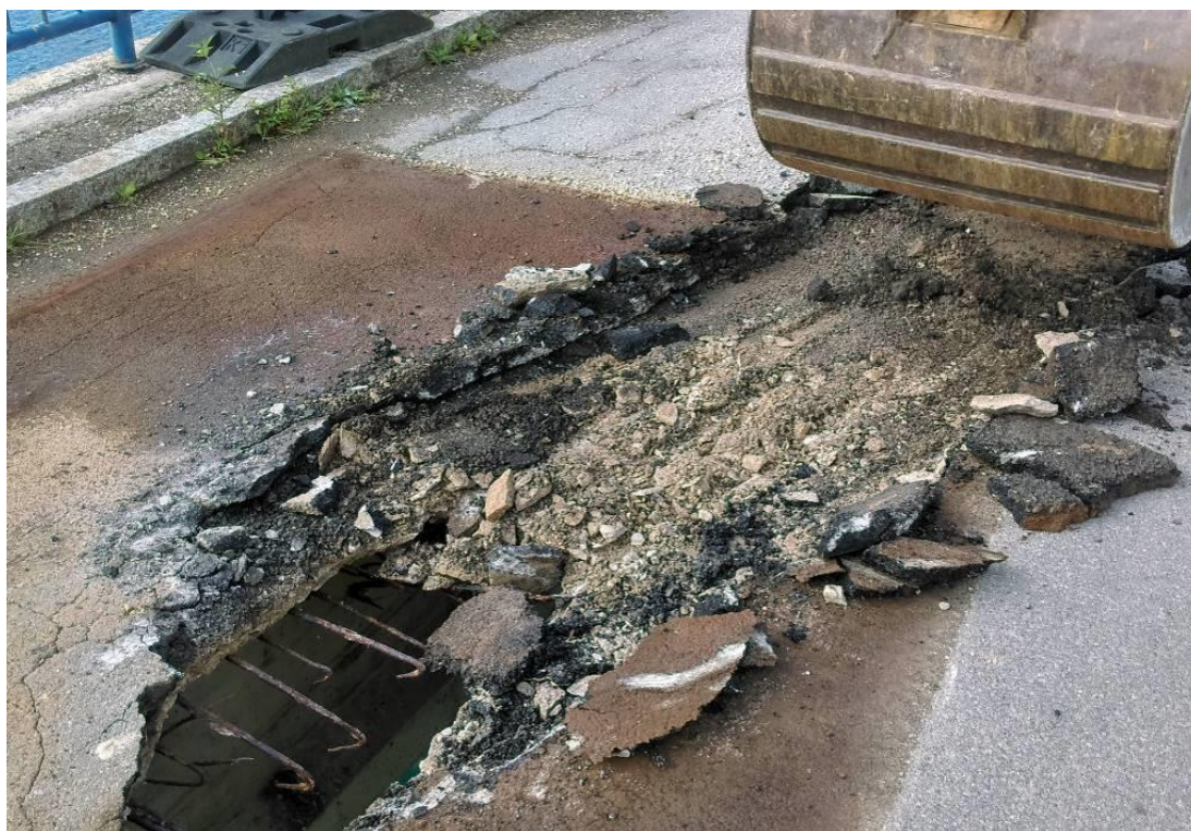
Slika 9. Oštećenje kolničke ploče mosta Klanac kod Gospića
