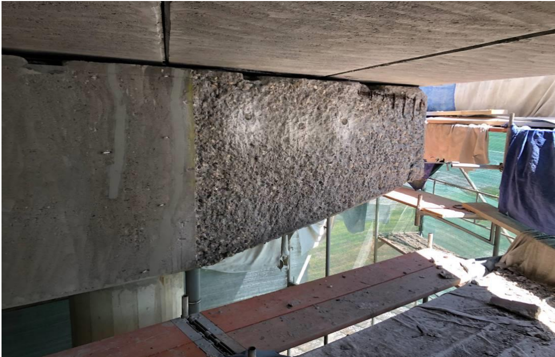
Slika 79. Naglavna greda nadvožnjaka s vidljivim dijelovima injektiranja pukotina, površine nakon hidrodinamičkog uklanjanja oštećenog betona i uzorci “pull off” ispitivanja
