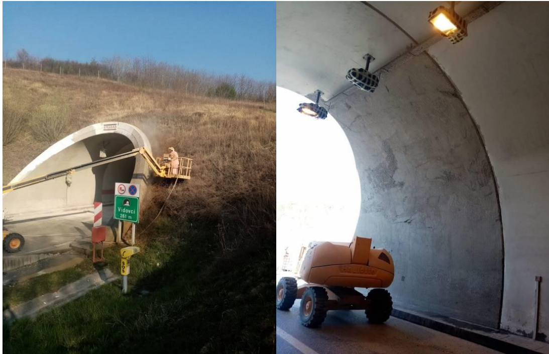
Slika 56. Hidrodinamičko čiščenje sekundarne obloge i vidljiva oštećenja obloge
