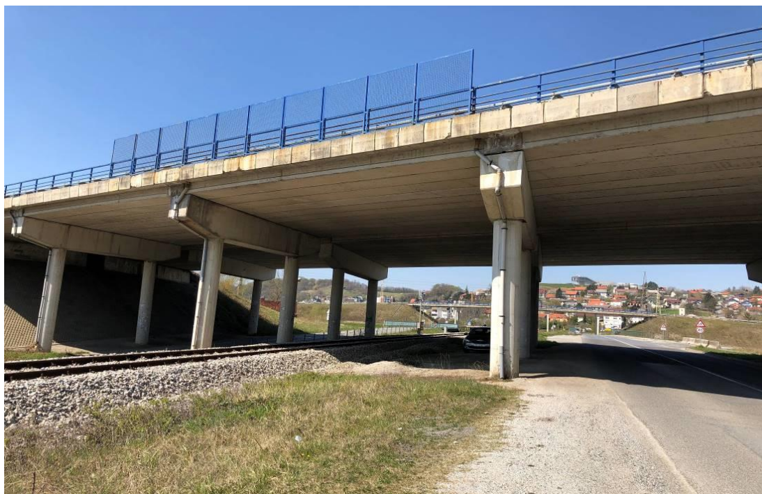
Slika 70. Zatečeno stanje nadvožnjaka s vidljivim oštećenjima
