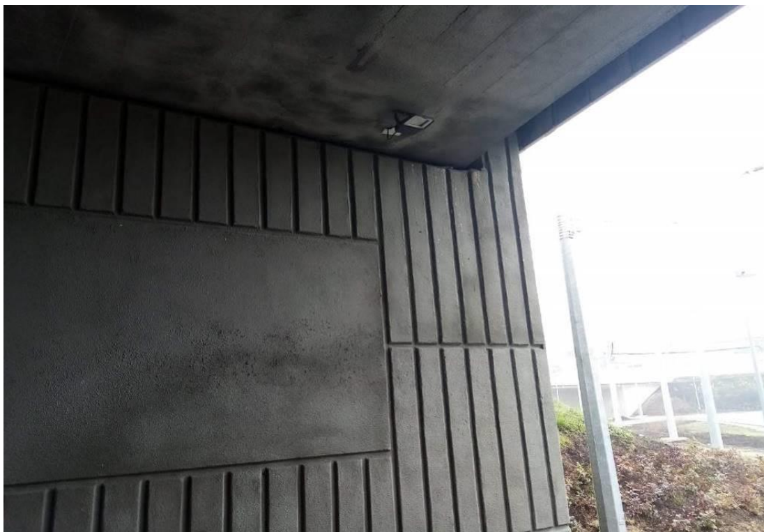
Slika 35. Kruti premaz/mort na prsnom zidu upornjaka
