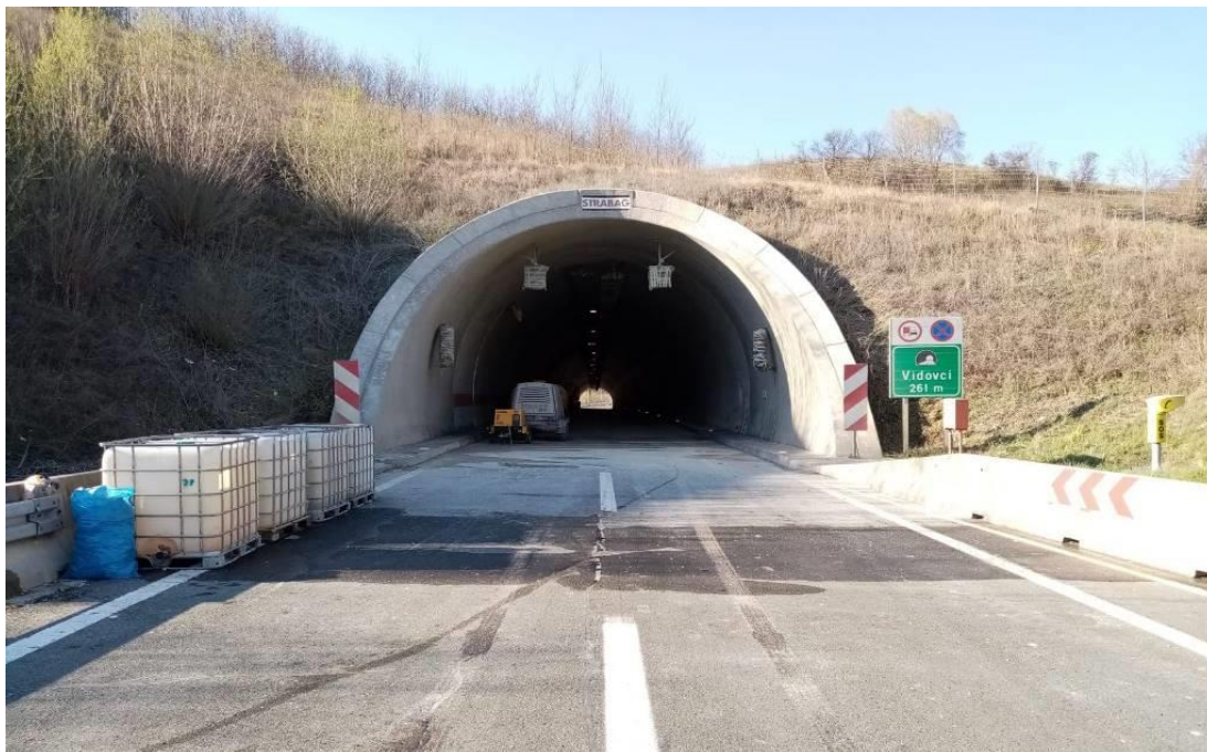
Slika 53 Zatečeno stanje obloge tunela prije izvedbe sanacijskih radova
