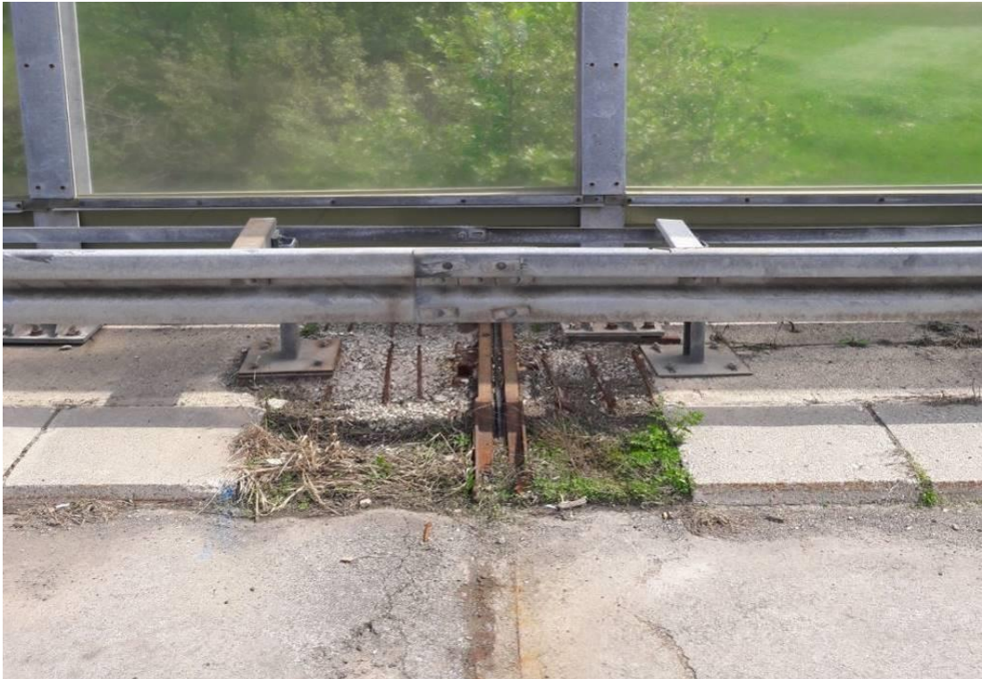
Slika 12. Oštećenje hodnika u zoni prijelazne naprave na mostu Kračevac
