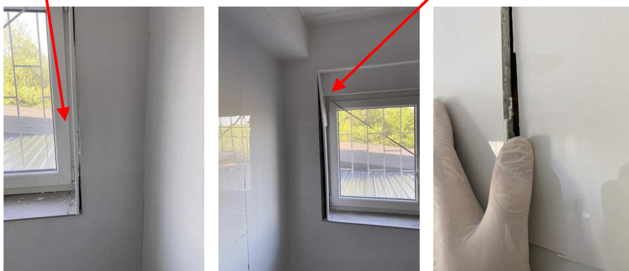
Slika 4.17. Sjeverni vanjski nosivi zid, oštećenja
