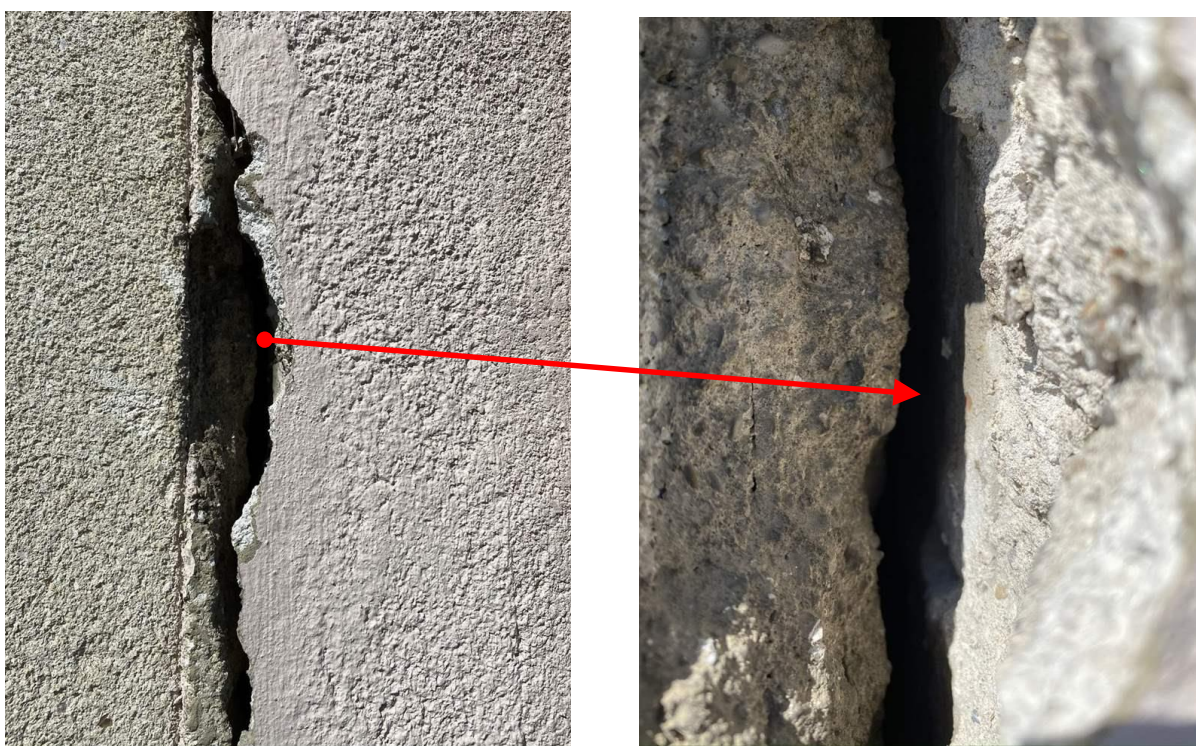
Slika 4.21. Dubinsko oštećenje na dilataciji građevina;
