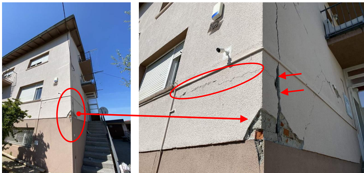
Slika 4.1. Konstruktivni jugoistočni kut stambene zgrade; maksimalna oštećenja;
