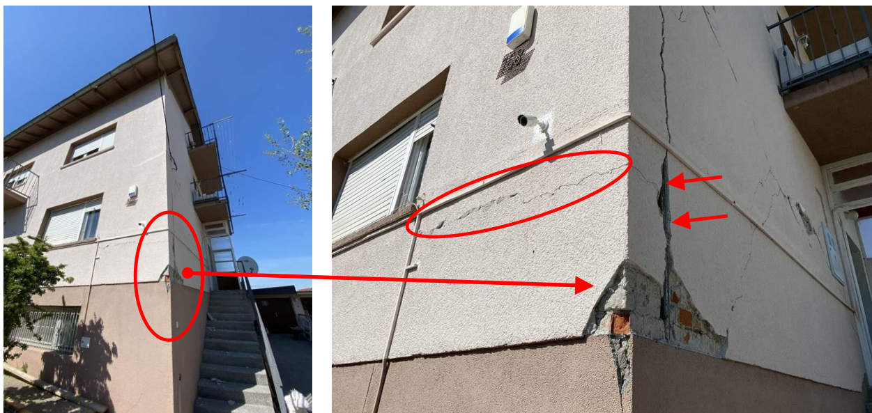
Slika 4.1. Konstruktivni jugoistočni kut stambene zgrade; maksimalna oštećenja;
