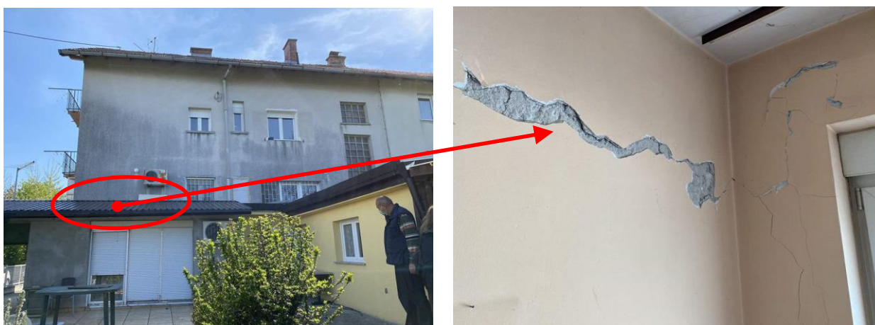
Slika 4.8. Nosivi zid na sjevernom zidu, SI kut (lijevo), pogled iz unutrašnjosti (desno);
