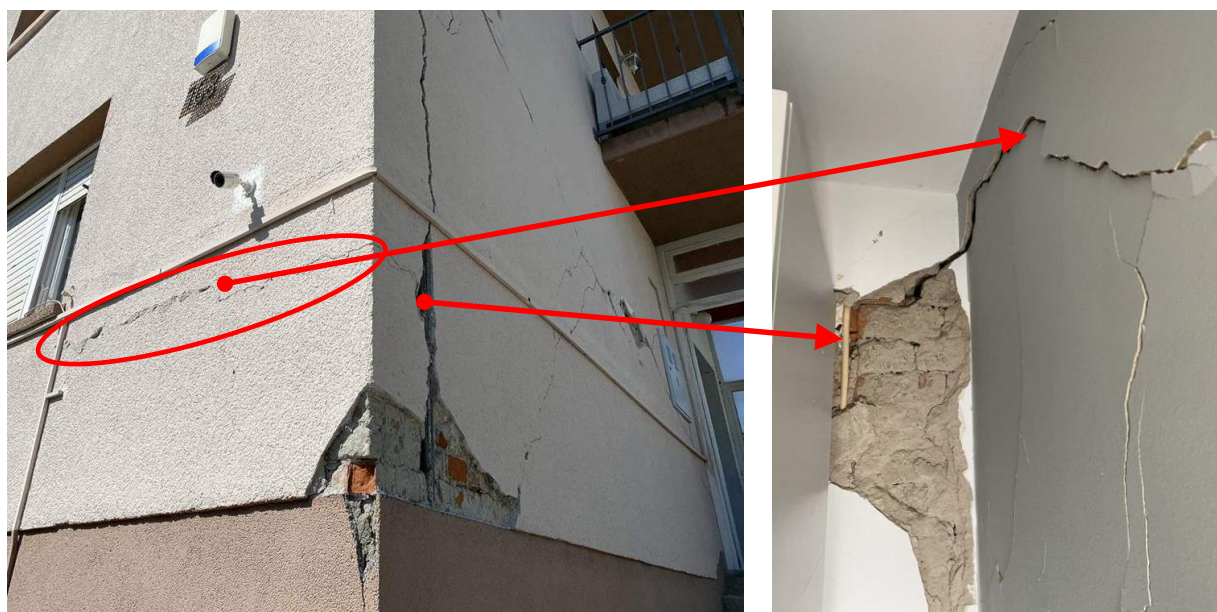
Slika 4.2. Konstruktivno slomljen južni zid; pogled iz vana i iz unutrašnjosti;
