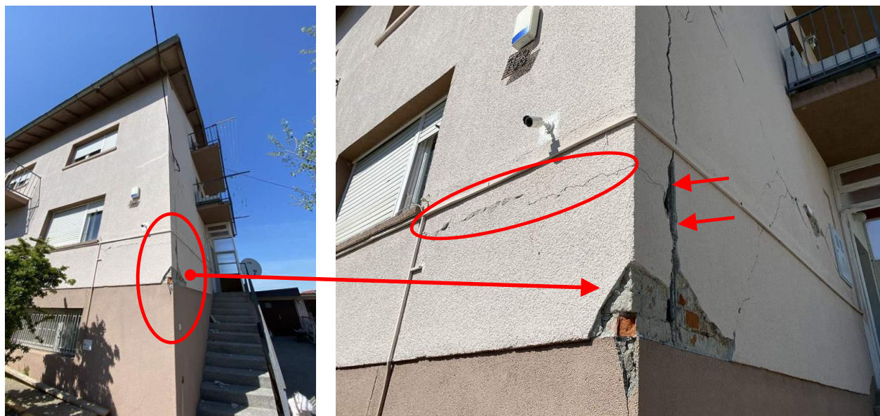
Slika 4.1. Konstruktivni jugoistočni kut stambene zgrade; maksimalna oštećenja;
