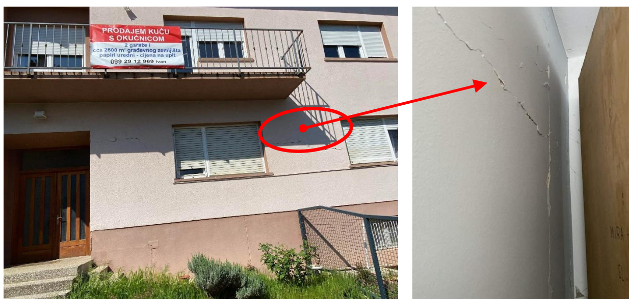
Slika 4.19. Vanjska pukotina konstruktivnog južnog zida prizemlja etaže 2 (desno), detektirana i u unutrašnjosti (lijevo);
