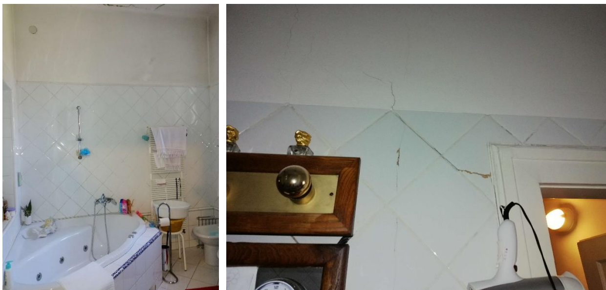
Slika 4.22. Pukotinska oštećenja u kupaonici
