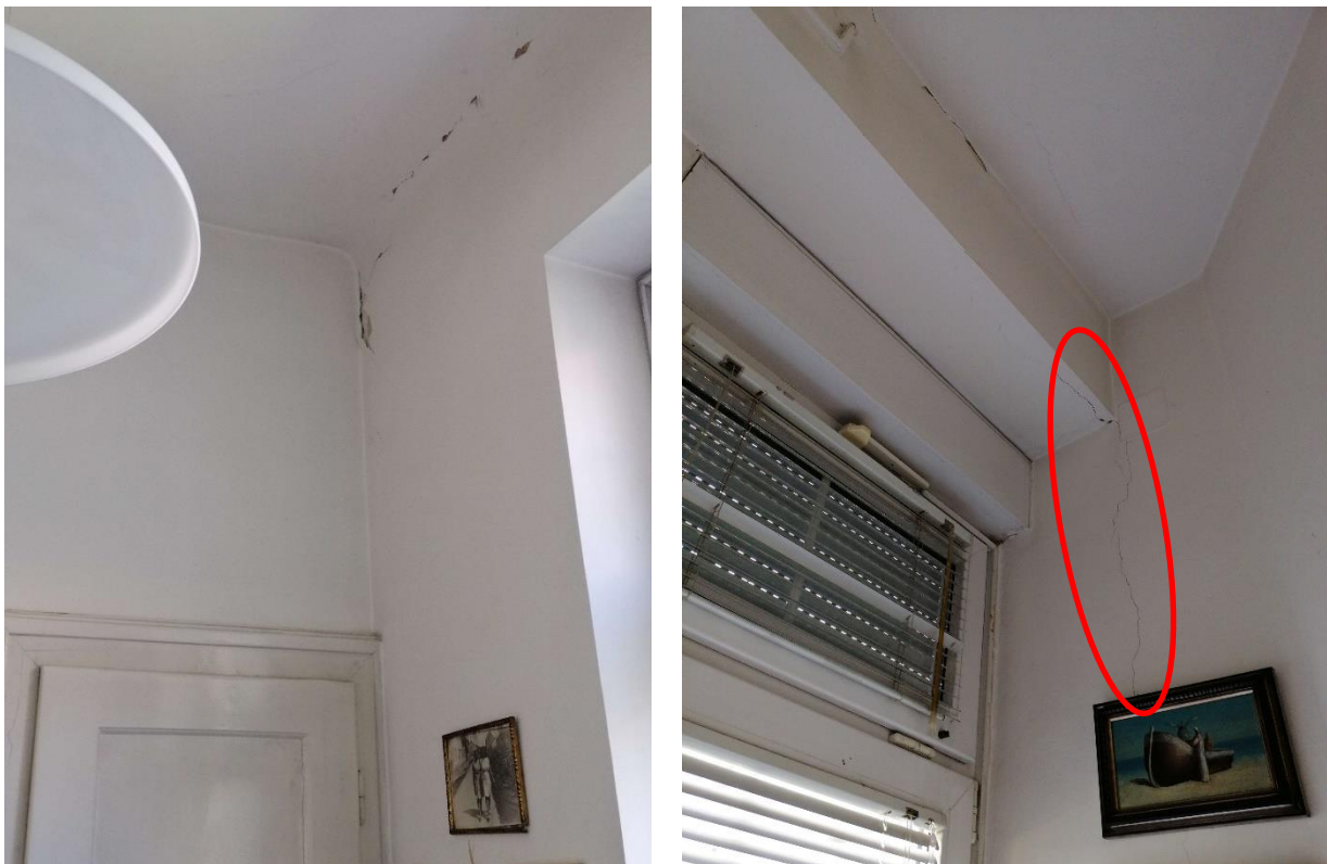
Slika 4.20. Spoj vertikalne i horizontalne pukotine; vanjski nosivi zid
