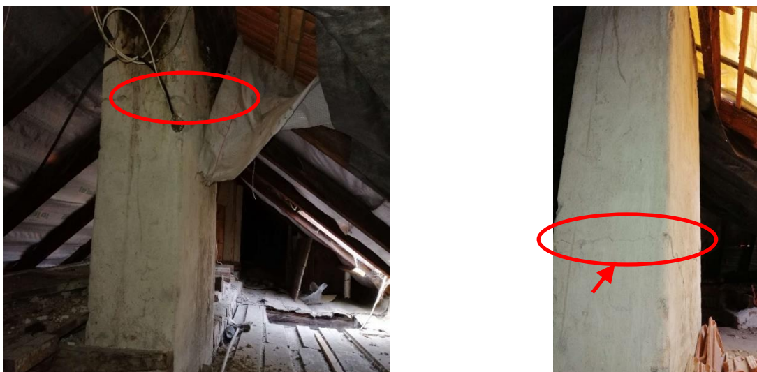
Slika 4.29. Horizontalna puknuća po visini dimnjaka
