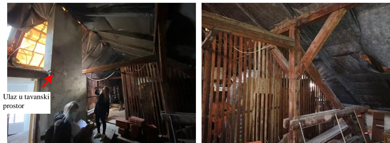
Slika 4.26. Oštećeni i odlomljeni dimnjak te nosiva konstrukcija krovišta
