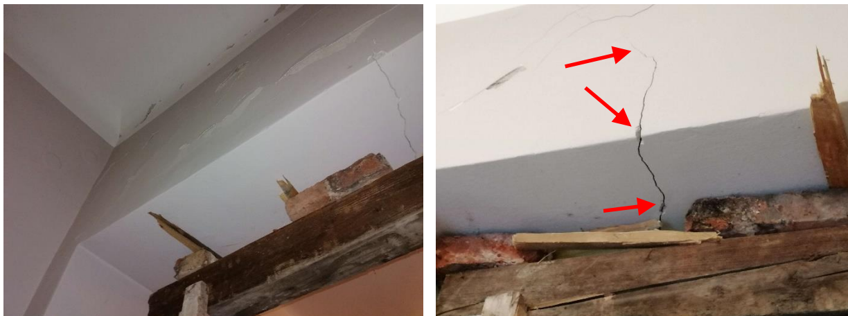
Slika 4.5. Jasno vidljiva struktura konstruktivne pukotine
