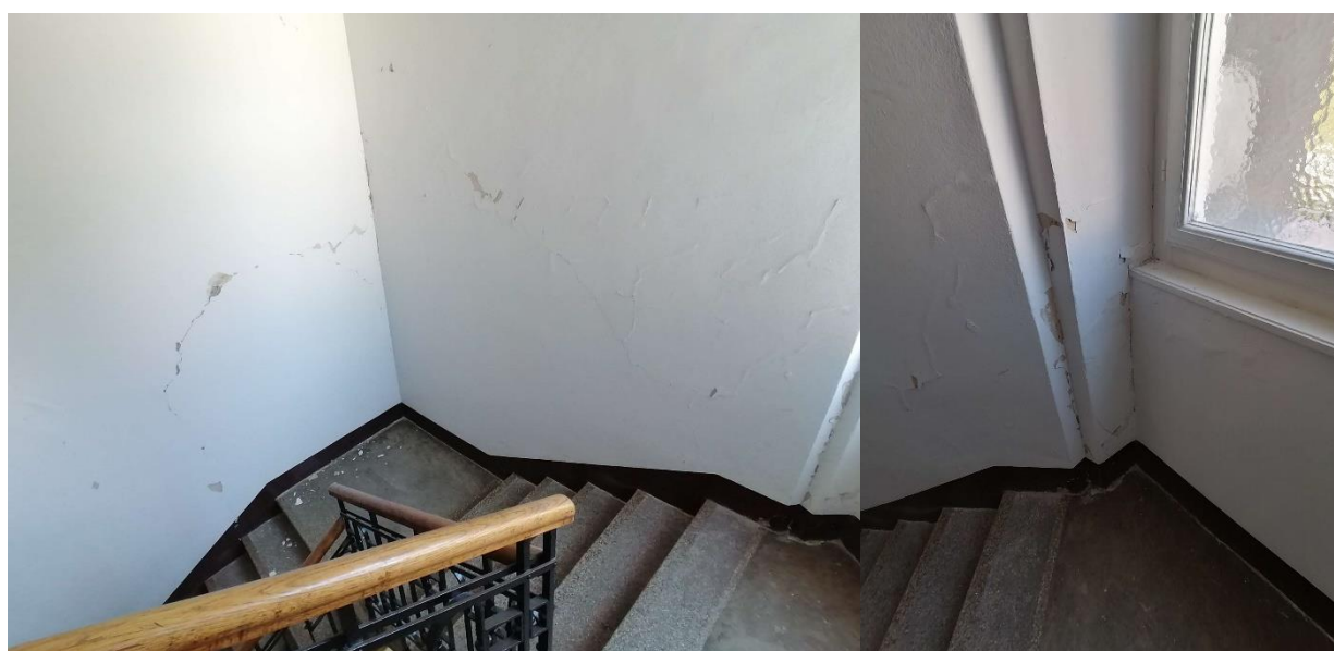
Slika 4.37. Površinska oštećenja na nosivim zidovima stubišnog prostora
