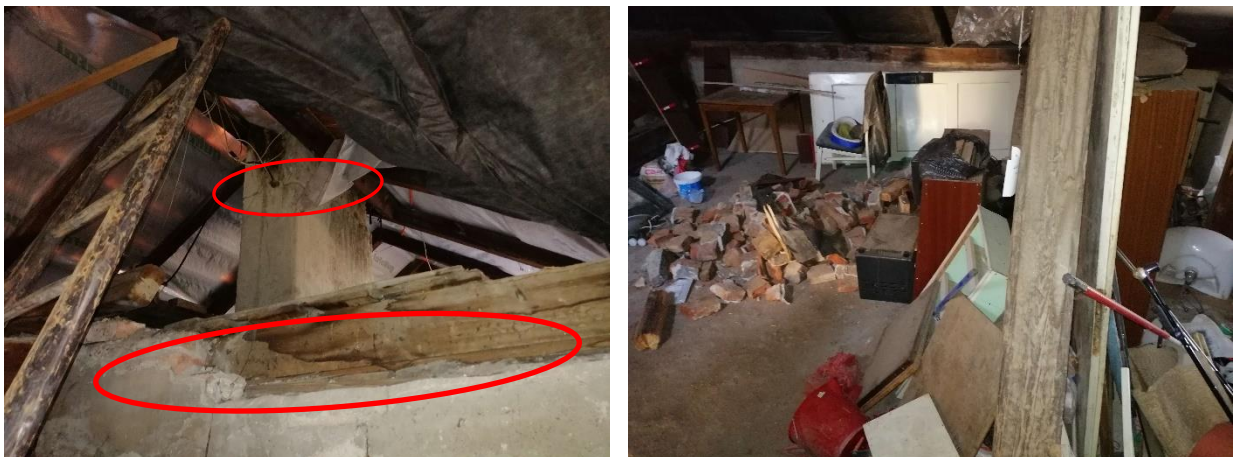
Slika 4.31. Oštećeno krovšte i odlomljeni dijelovi i oštećenja nastalom u trenutku potresa
