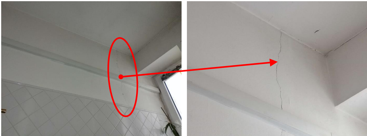
Slika 4.10. Vertikalne pukotine na vanjskim krajnjim nosivim zidovima
