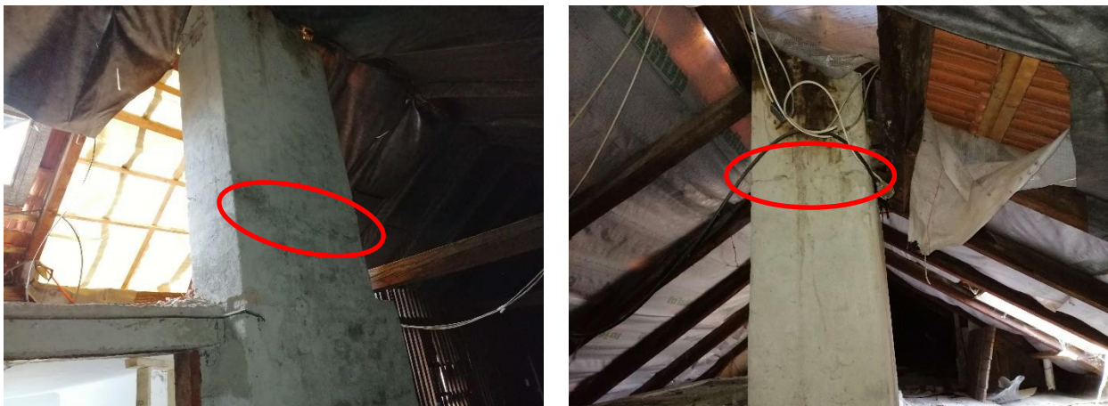
Slika 4.28.. Pukotinska oštećenja dimnjaka ispod krovne površine
