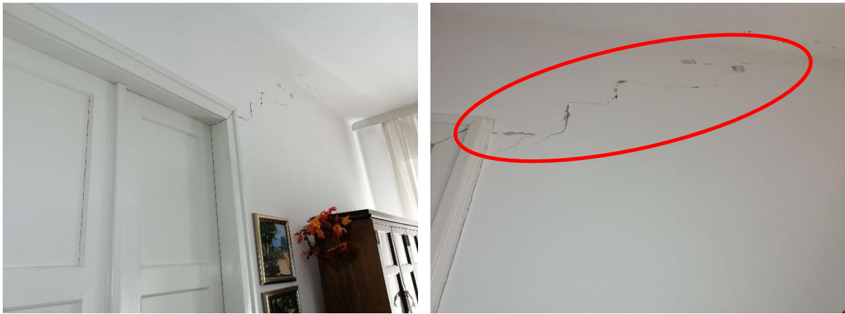
Slika 4.6. Pukotine u poprečnom nenasivom zidu
