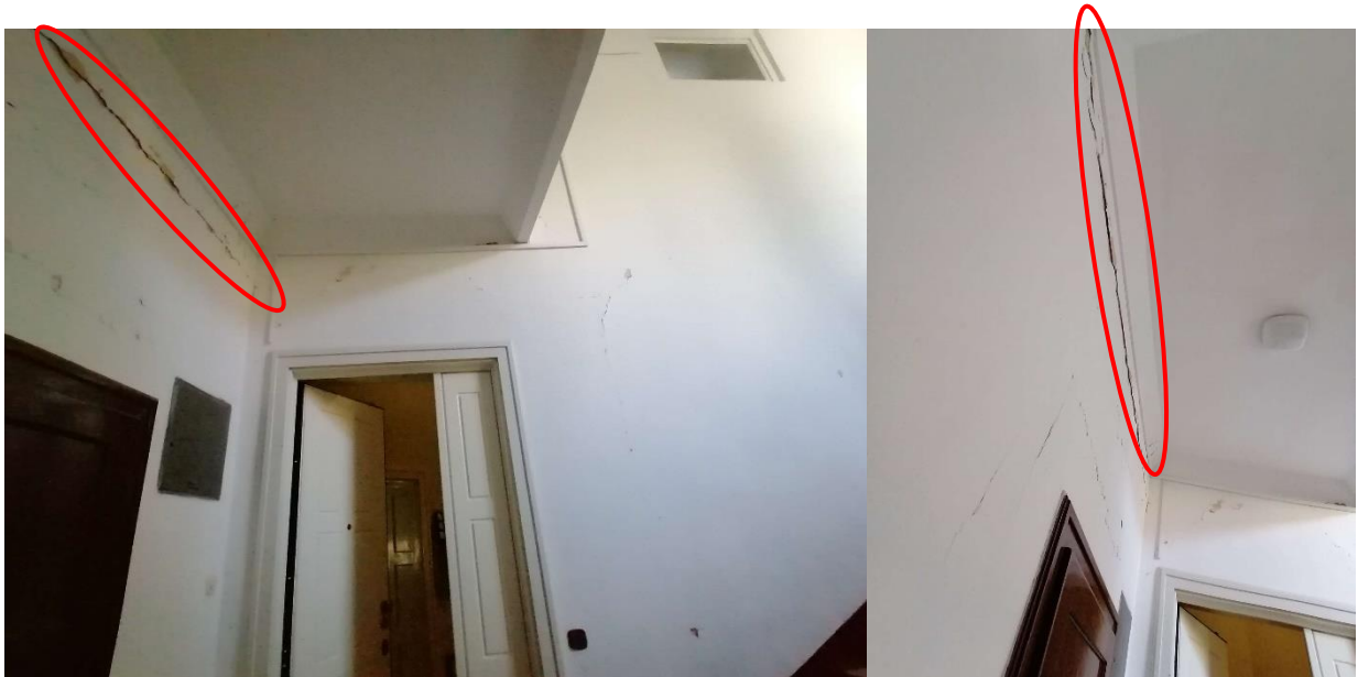
Slika 4.39. Već karakteristične horizontalne pukotine na spojevima zidova i stropova
