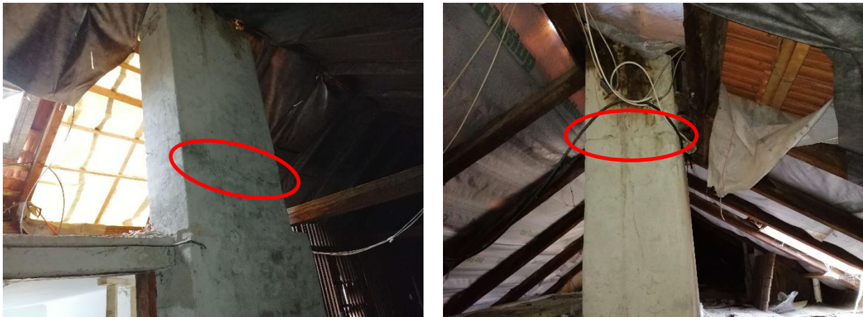
Slika 4.28.. Pukotinska oštećenja dimnjaka ispod krovne površine
