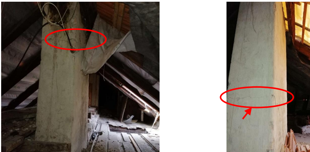
Slika 4.29. Horizontalna puknuća po visini dimnjaka
