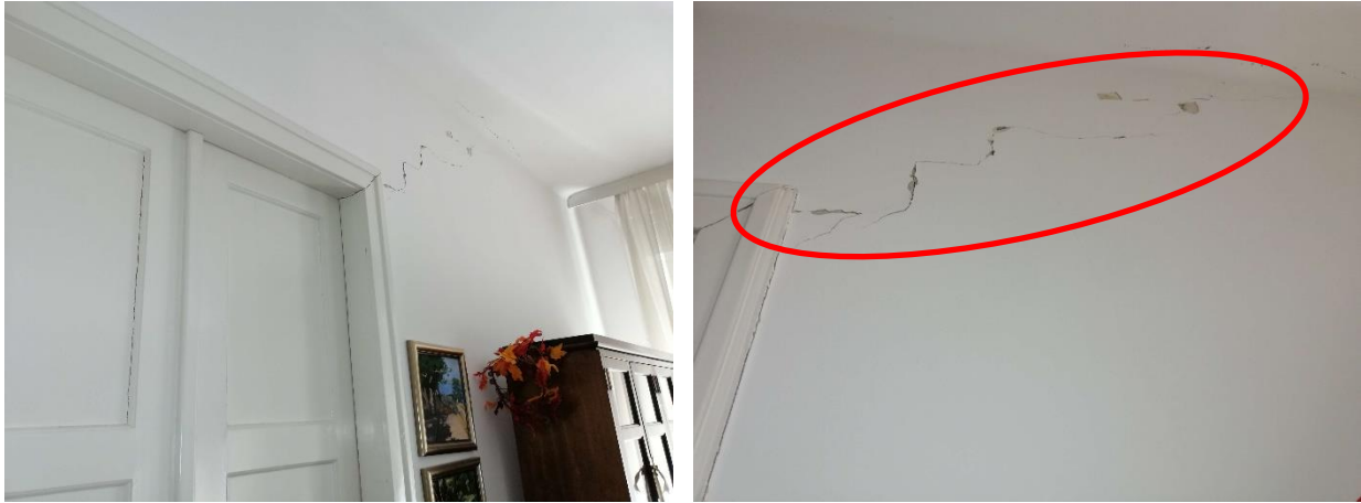
Slika 4.6. Pukotine u poprečnom nenosivom zidu
