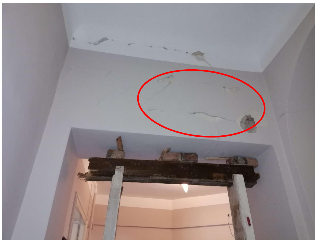
Slika 4.4. Pogled hodnikom u smjeru zapada prema oštećenom nadvoju
