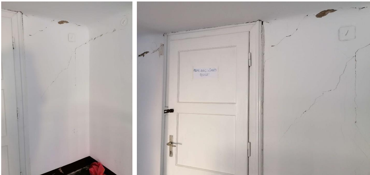
Slika 4.33. Pukotine po nosivim zidovima stubišta
