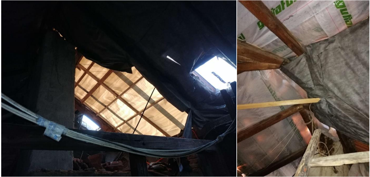
Slika 4.32. Oštećene krovne plohe, potrebna zamjena krovnog pokrova te adekvatna i stručna sanacija
