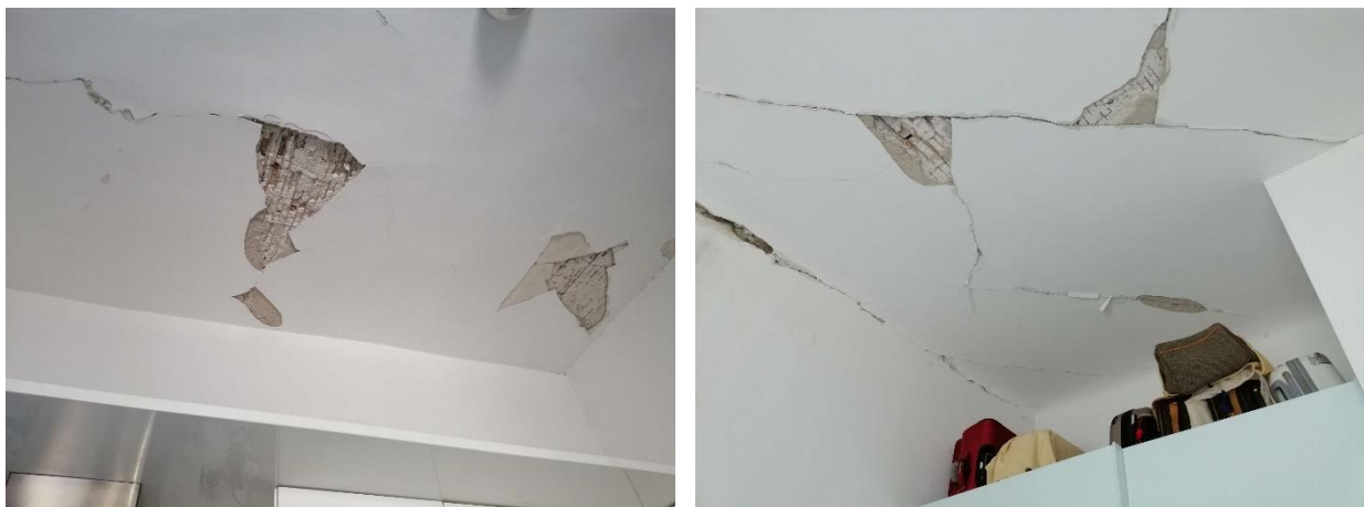
Slika 4.15. Dijagonalne pukotine po cijeloj površini stropa
