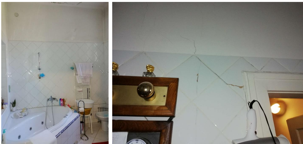
Slika 4.22. Pukotinska oštećenja u kupaonici
