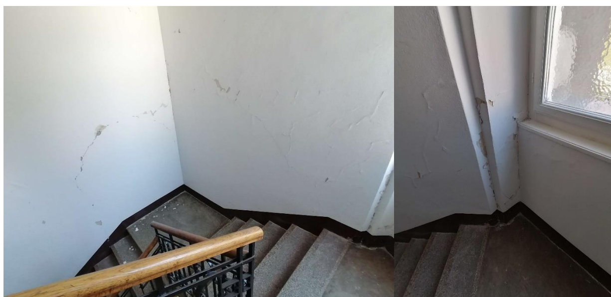
Slika 4.37. Površinska oštećenja na nosivim zidovima stubišnog prostora
