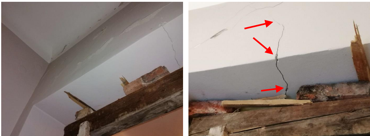
Slika 4.5. Jasno vidljiva struktura konstruktivne pukotine
