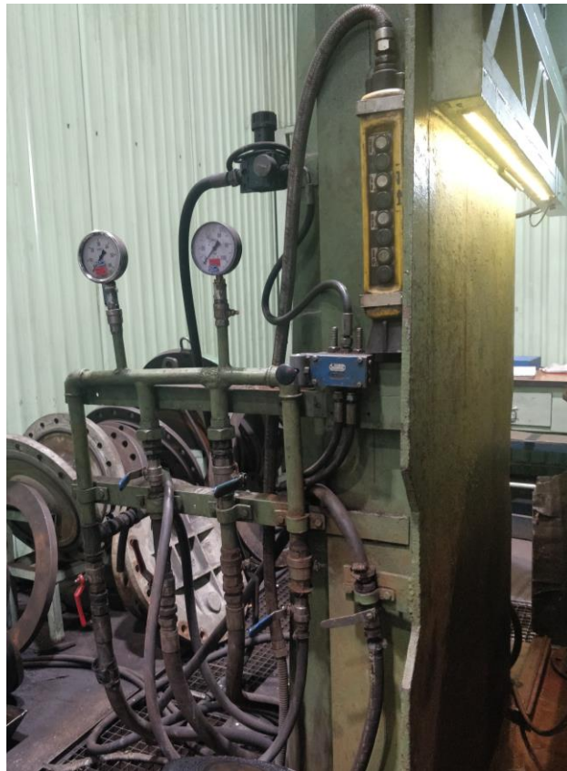
Slika 17. Oprema za mjerenje
