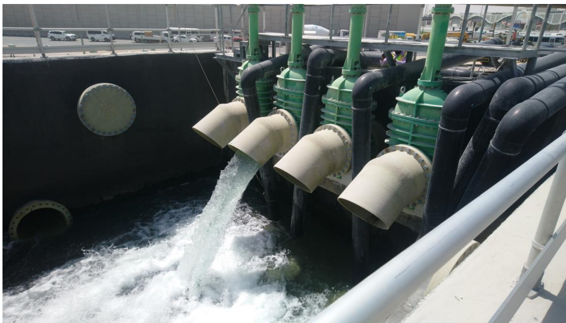
Slika 11. Ovalni zasuni ugrađeni u Kataru, Doha (New Orbital Highway)
