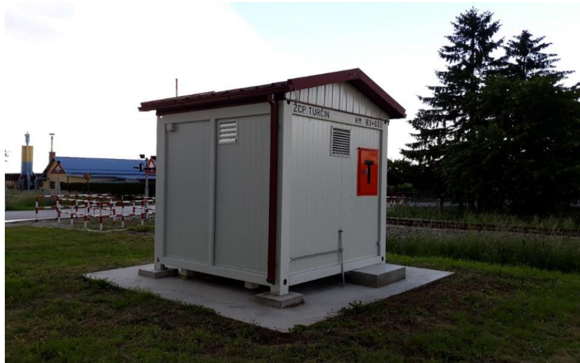
Slika 51. Kućica za smještaj unutrašnjih dijelova uređaja
