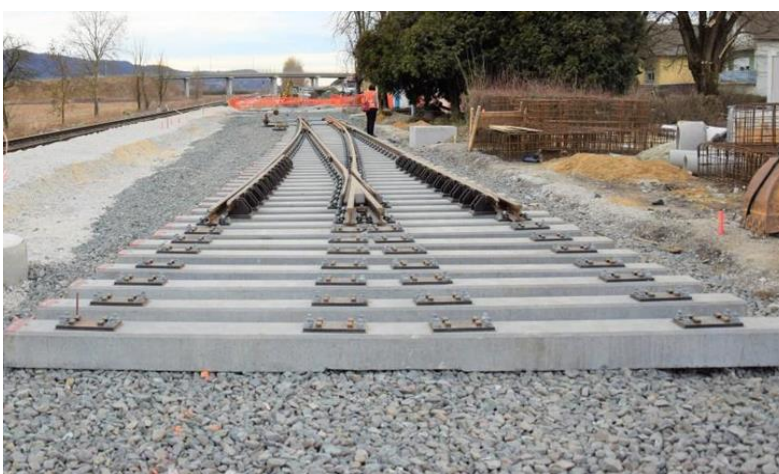
Slika 42. Željeznička skretnica na betonskim pragovima
