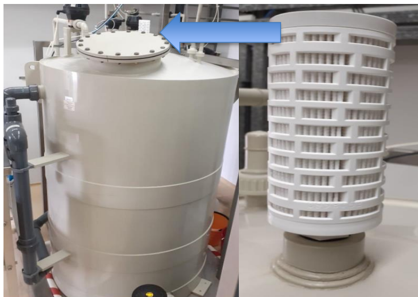
Slika 3.3. Spremnik gradske vode s odzračnim filterom poroznosti 0,01 µm (vlastiti izvor)
