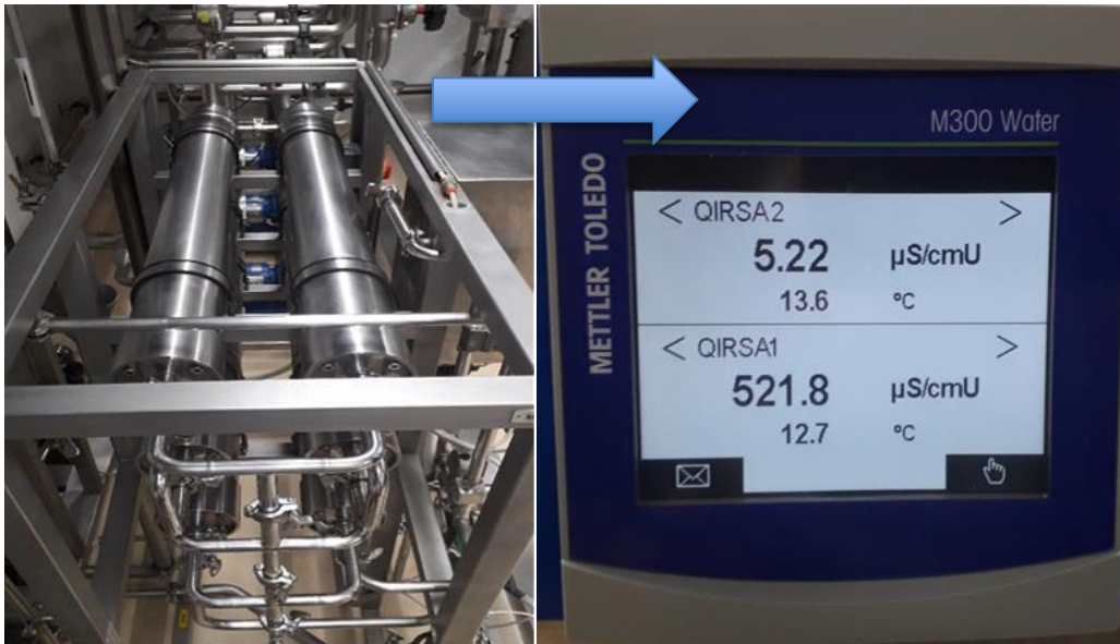
Slika 3.15. Kućište membrana RO i vrijednosti ulaza i izlaza vode na RO (vlastiti izvor)
